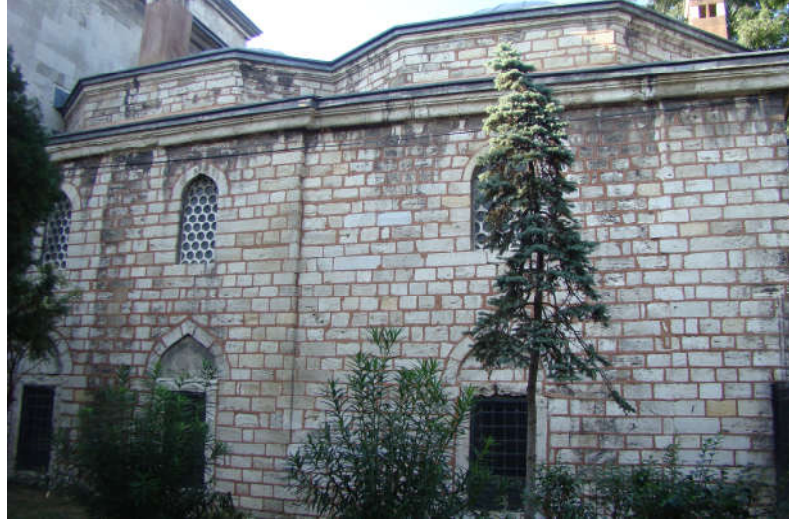
Şekil 5. 19 Fatih Tabhanesi güney cephesi hasarlar [Y. Örs, 2010]
