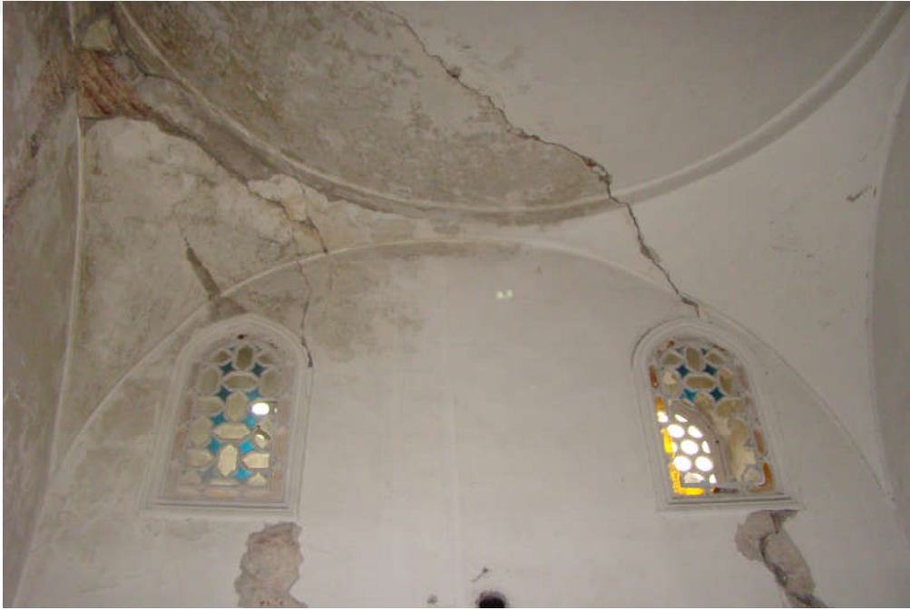
Şekil 5. 14 Fatih Tabhanesi odalardaki yapısal ve yüzeysel çatlaklar [Y. Örs, 2011]
