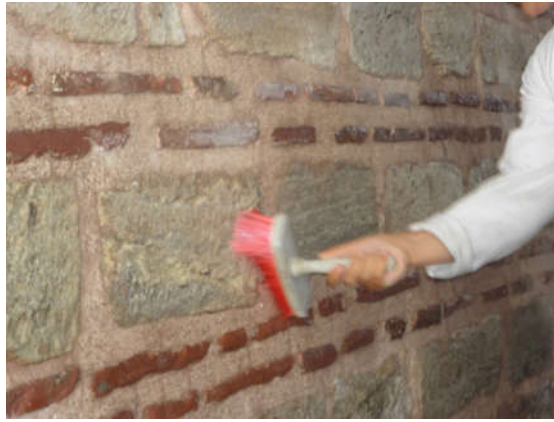
Şekil 5. 87 Fatih Tabhanesi cephelerine yüzey sağlama ve su itici malzeme uygulaması yapılması [Y. Örs, 2012]
