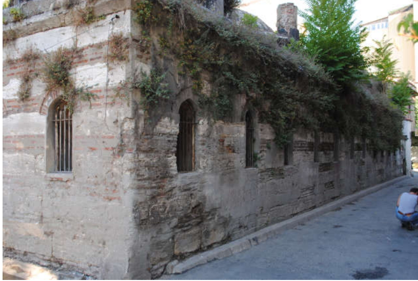
Şekil 5. 6 Bitkilerin tarihi yapıya verdiği tahribat (Kılıç Ali Paşa Medresesi) [Y. Örs, 2013]
