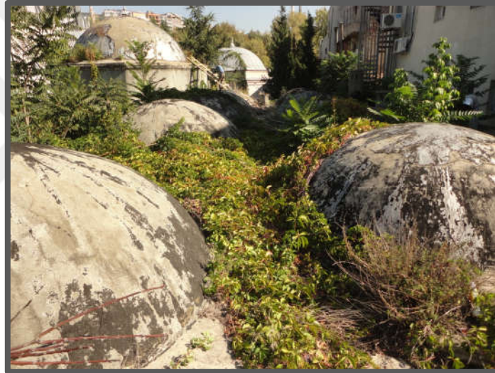
Şekil 5. 7 Bitkilerin tarihi yapıya verdiği tahribat (Kılıç Ali Paşa Medresesi) [Y. Örs, 2013]
