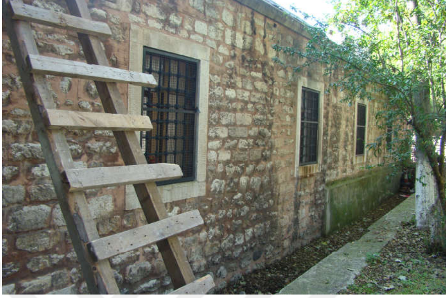
Şekil 5. 18 Fatih Tabhanesi cephe duvarlarında su etkeni sebebiyle oluşmuş hasarlar [Y. Örs, 2010]
