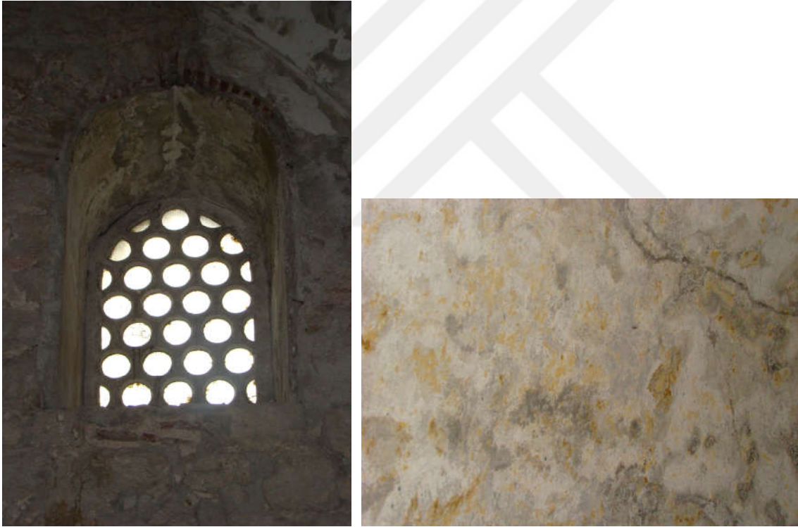
Şekil 5. 17 Fatih Tabhanesi su etkeni sebebiyle oluşmuş hasarlar [Y. Örs, 2010]
