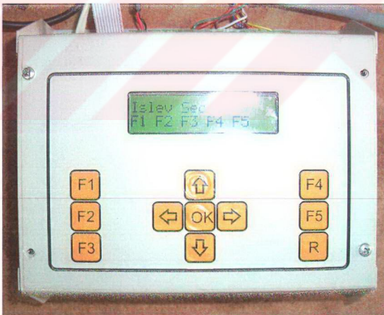
Şekil 4.11 Merkezi kontrol ünitesi
