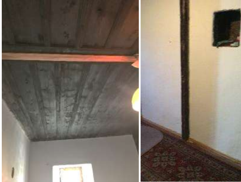
Şekil 5. 4 Duvarda ve tavanda bulunan izler, 2018 [11]
