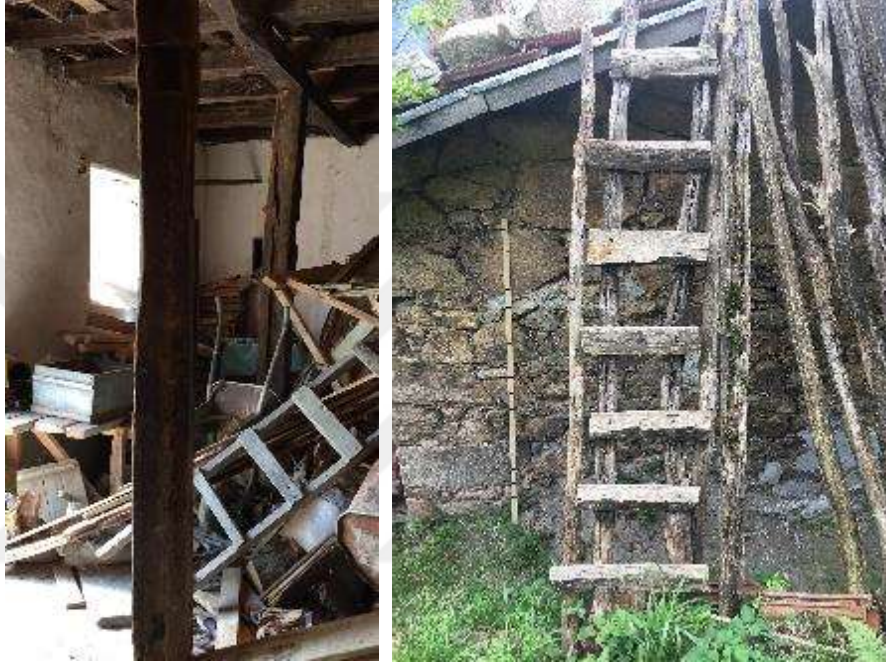
Şekil 4. 55 Dikme ve cephede bulunan bozulmalar, 2018 [11]
