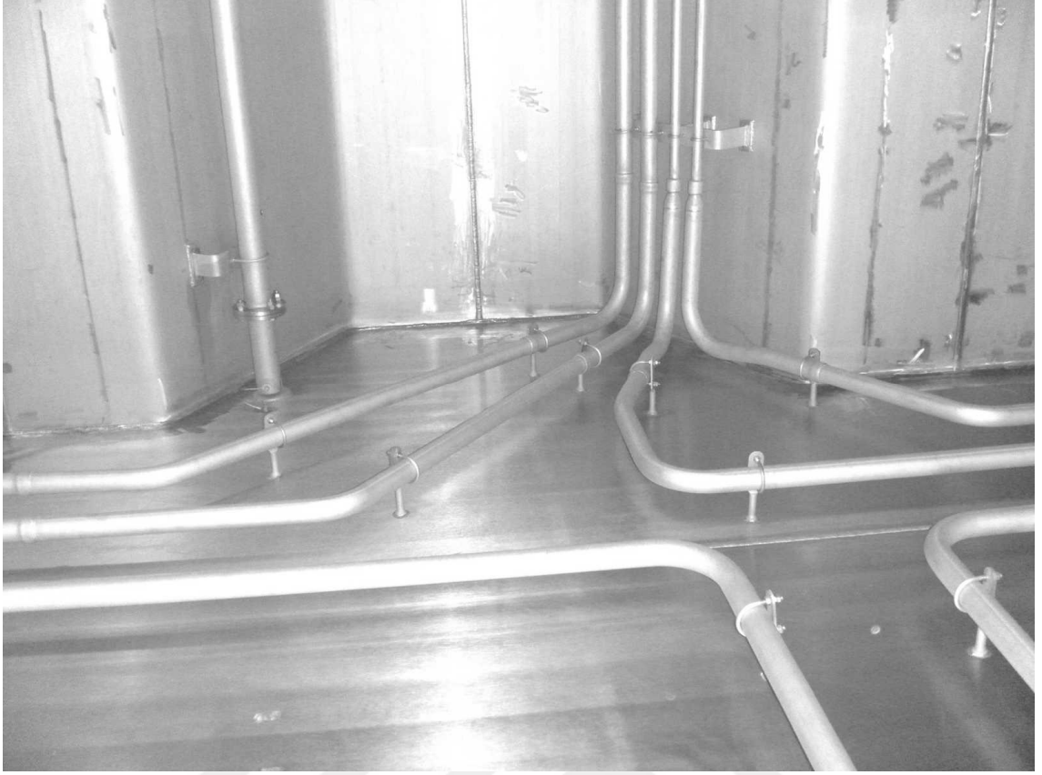
Şekil 5.1 Paslanmaz çelik tank
