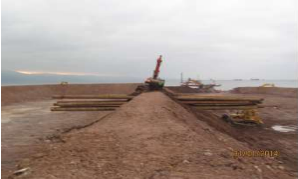
Şekil 5.3. Havuzlar Arası İletim Boruları
