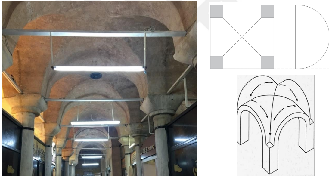
Şekil 7.2 Myrelaion sarnıcı çapraz tonoz görüntüsü [44] ve çapraz tonozun plan, kesit ve görünüşü [64]
