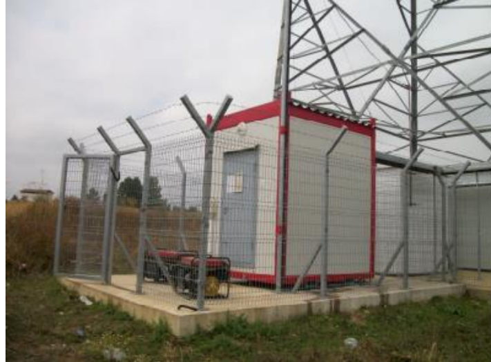
Şekil 6.5. Bir baz istasyonunun görünüşü
