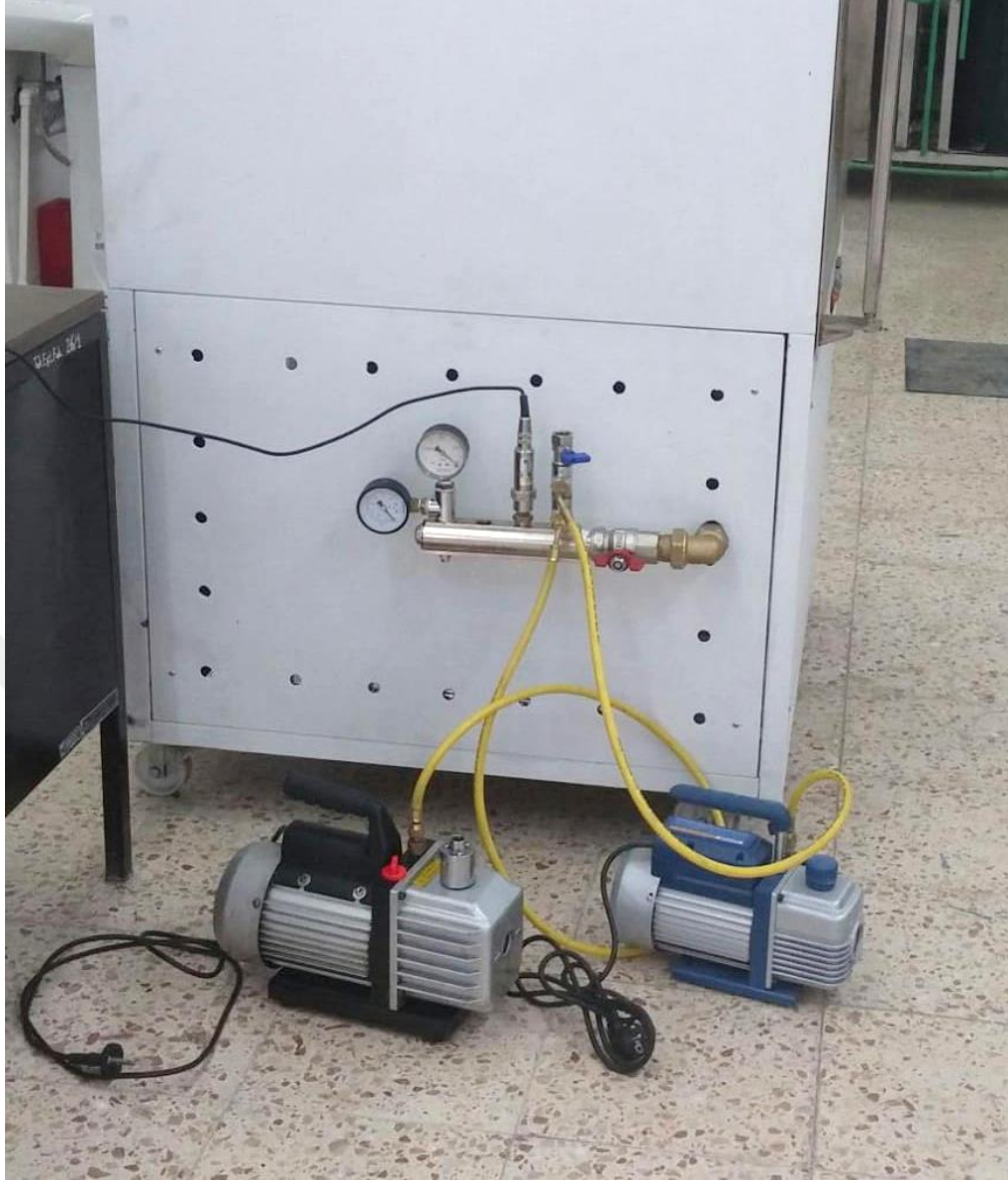
Şekil 3.6. Kurutma sistemi vakum pompası
