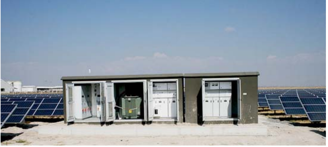
Şekil 3.27. Köşk trafo merkezi (Eltes, 2019)
