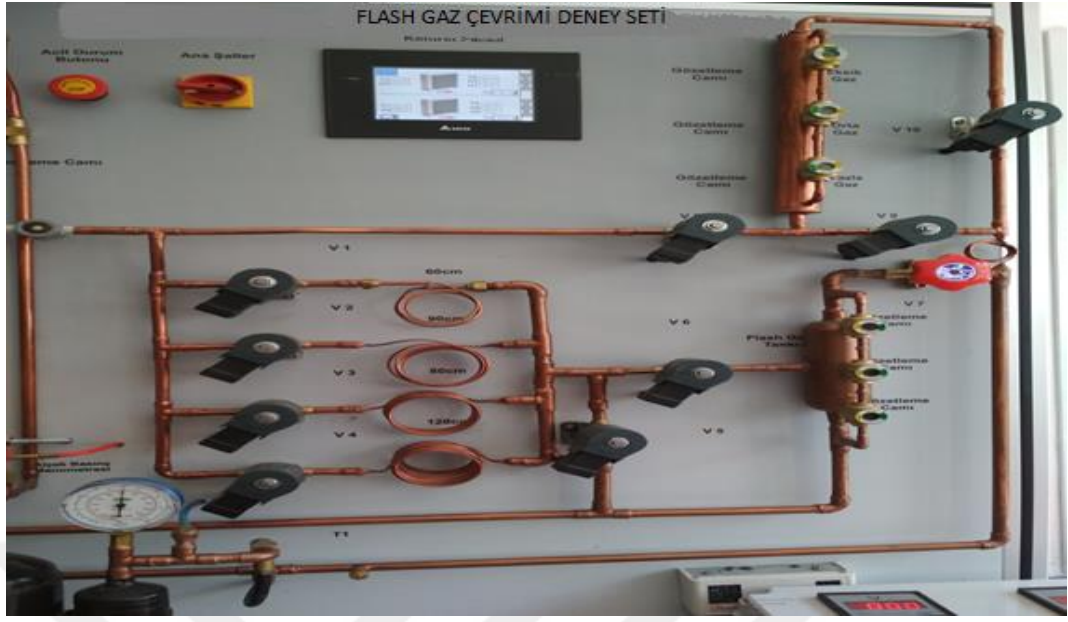
Şekil 3.6. Flaş gaz deney setindeki flaş gaz tankı ve akümülatör
