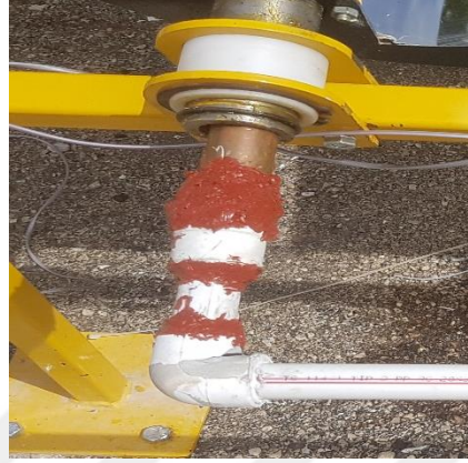
Şekil 3.25. Tesisat üzerindeki bakır-plastik boru birleşim noktaları
