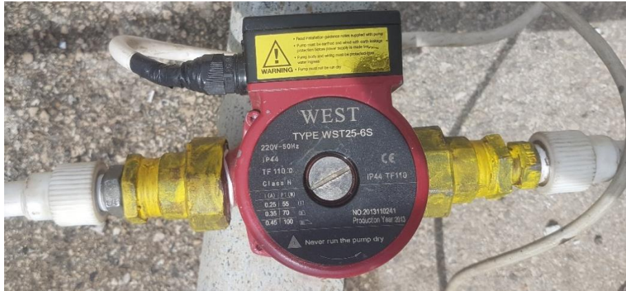
Şekil 3.20. Tesisat üzerindeki kalorifer pompası
