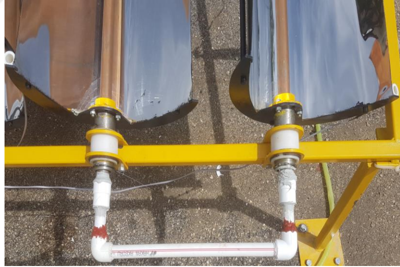
Şekil 3.22. Seri bağlanmış hücrelerin tesisatı
