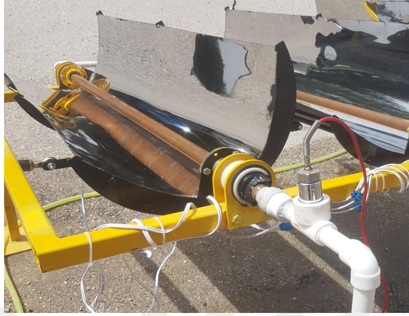
Şekil 3.21. Tesisat üzerindeki giriş suyu sıcaklığını ölçen termokupl bağlantısı
