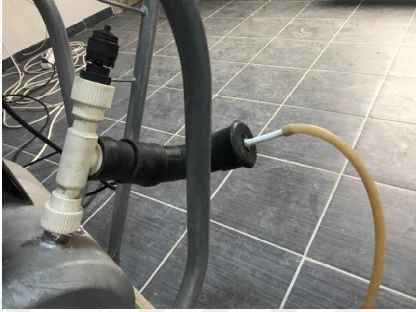
Şekil 3.11. Regülatör yakınında bağlantı
