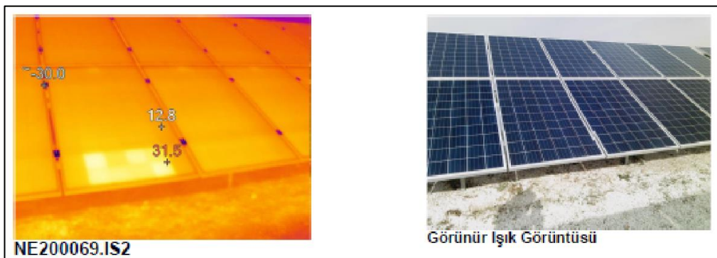
Şekil 4.5. Sistemdeki 9. dizide alt kısımdaki 16. panelin termal kamera görüntüsü
