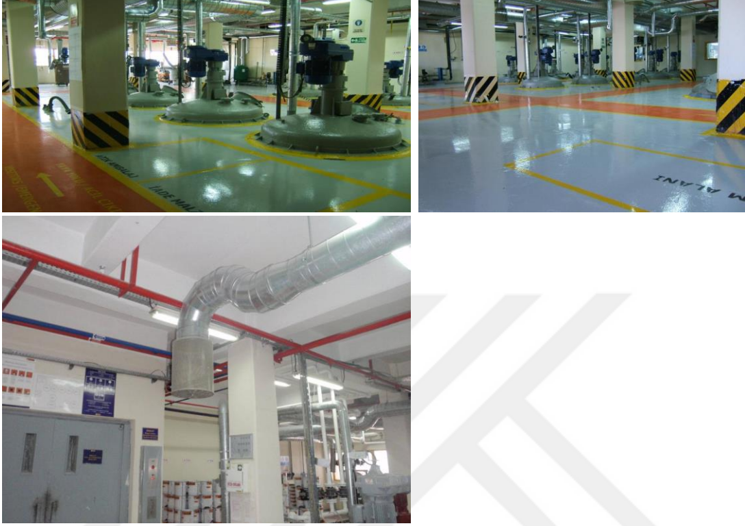
Resim 27 Exproof Havalandırma Sistemi
