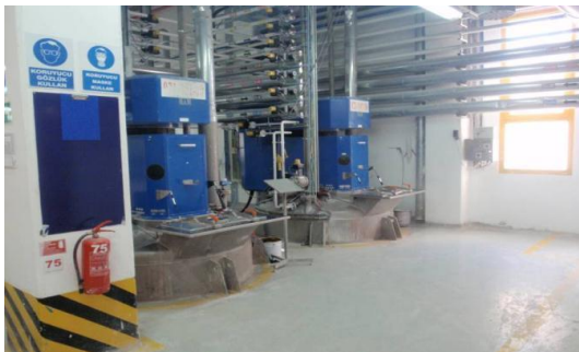
Resim 9 Boya fabrikası exproof kazan sistemleri
