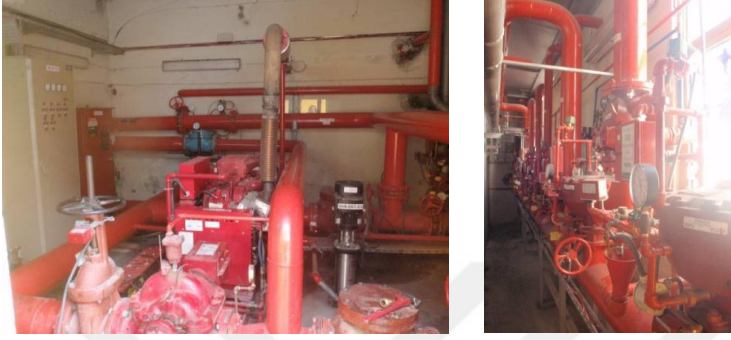
Resim 21 Yangın söndürme sistemi
