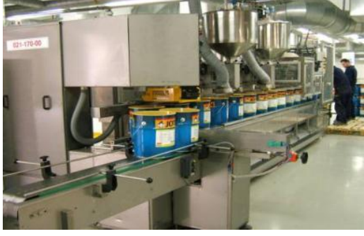
Resim 10 Boya fabrikası exproof kazan sistemleri
