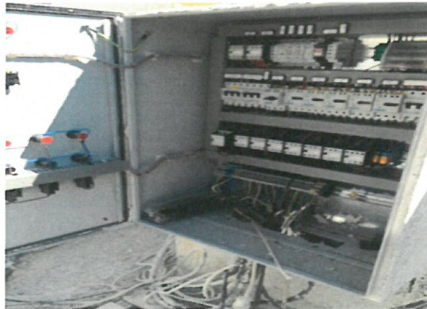
Resim 3: Elektrik panosu kapak açık görüntüsü
