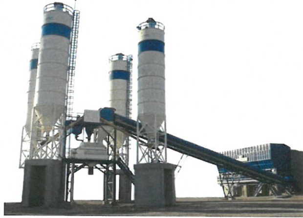
Resim 1: Hazır beton tesis görüntüsü
