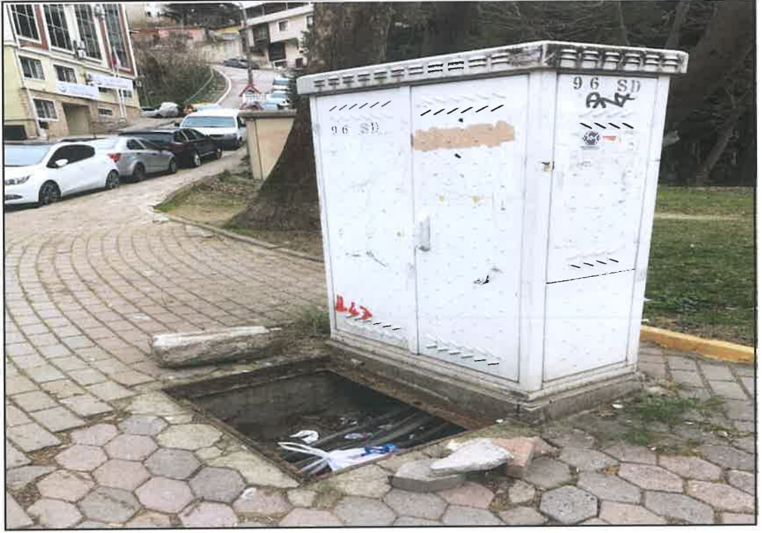
Resim 6: Elektrik Direkleri Ve Kutularının Kullanımı
