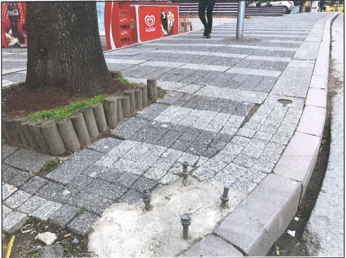
Resim 9.1: Kaldırımlardaki Tehlikeli Çıkıntılar
