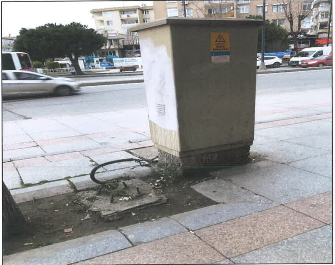
Resim 6.1: Elektrik Direkleri Ve Kutularının Kullanım
