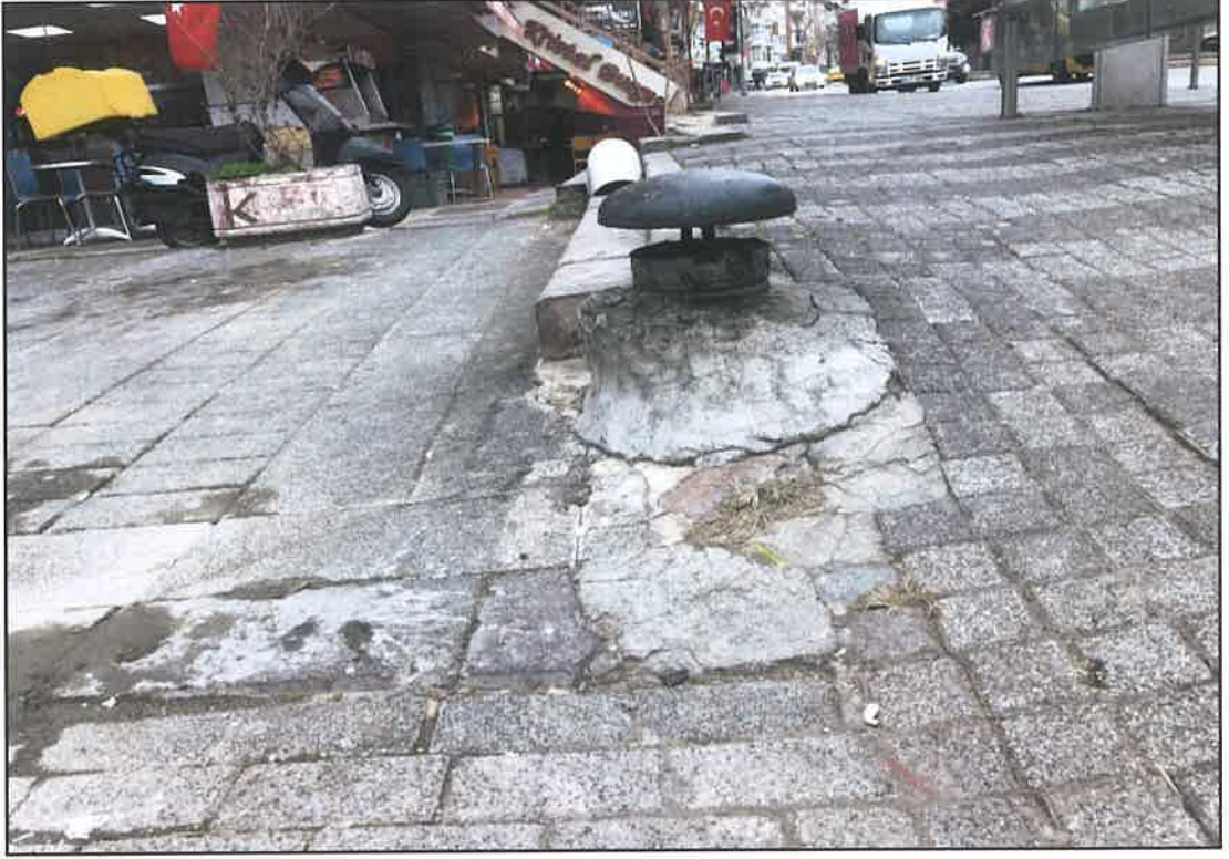
Resim 9: Kaldırımlardaki Tehlikeli Çıkıntılar
