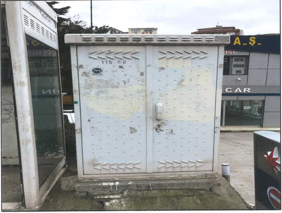
Resim 6.4: Elektrik Direkleri Ve Kutularının Kullanım
