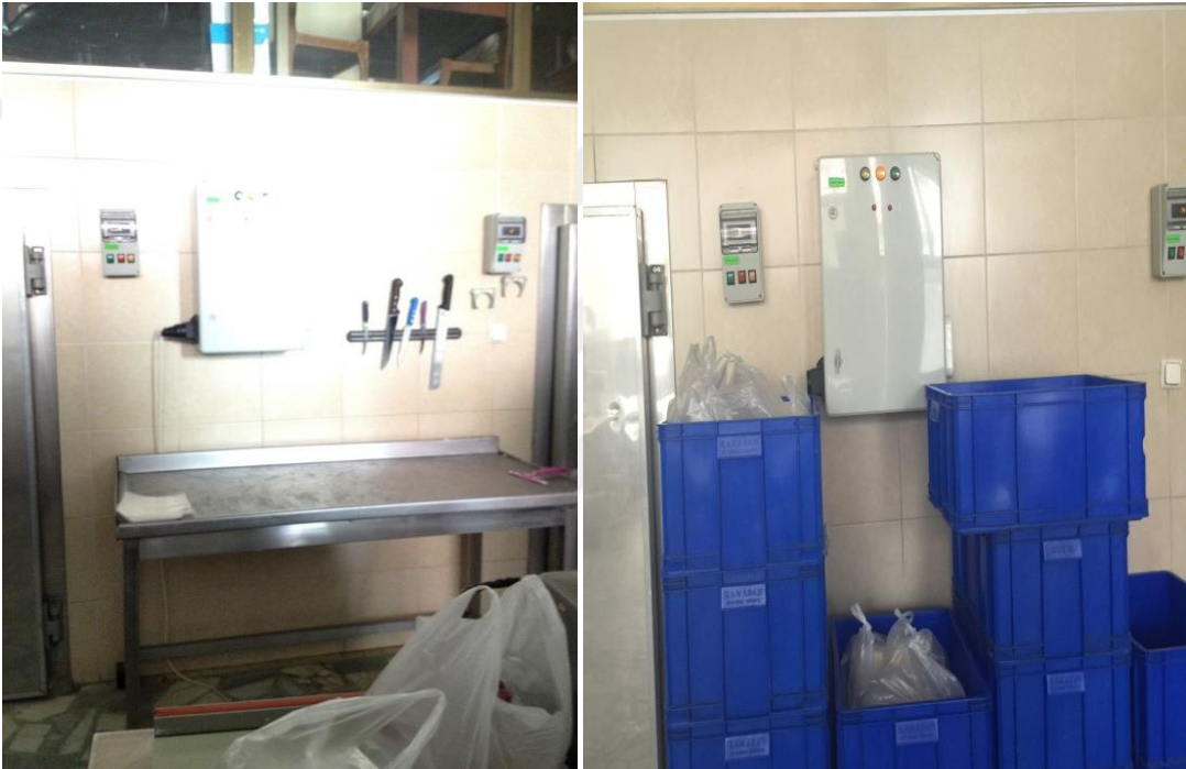
Resim 13: Soğuk hava depoları elektrik panoları görselleri
