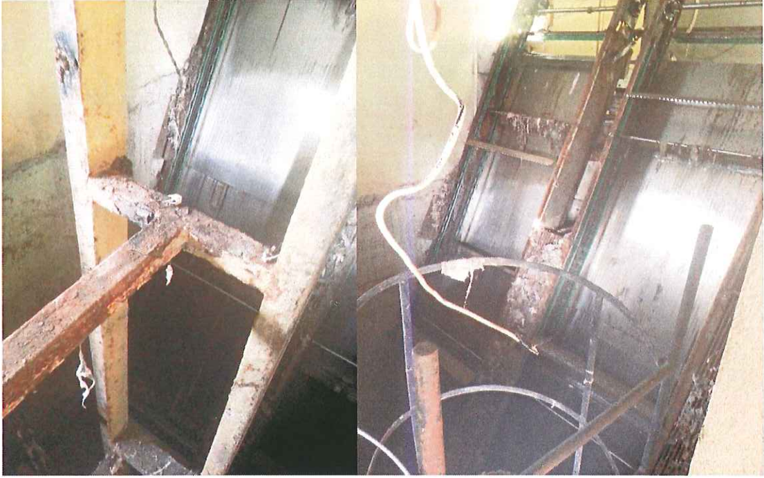
Resim 2: Mezitli Atıksu Arıtma Tesisi tarak kısımları
