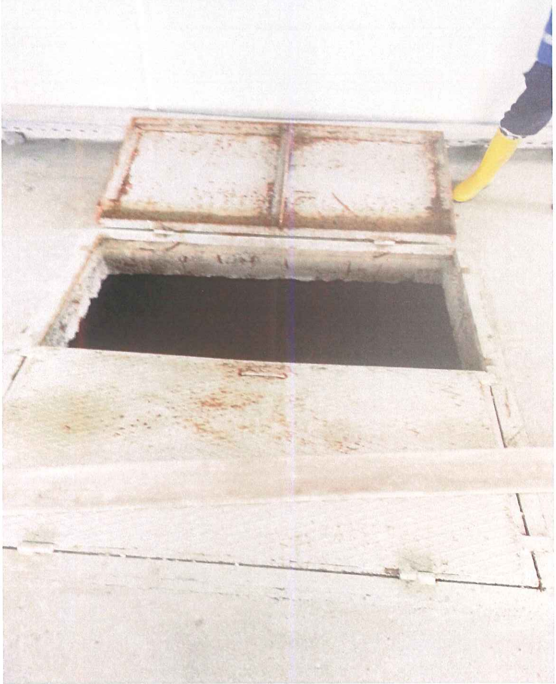
Resim 7: Merkez Pompa Atısu Terfi İstasyonu kapalı alan girişi
