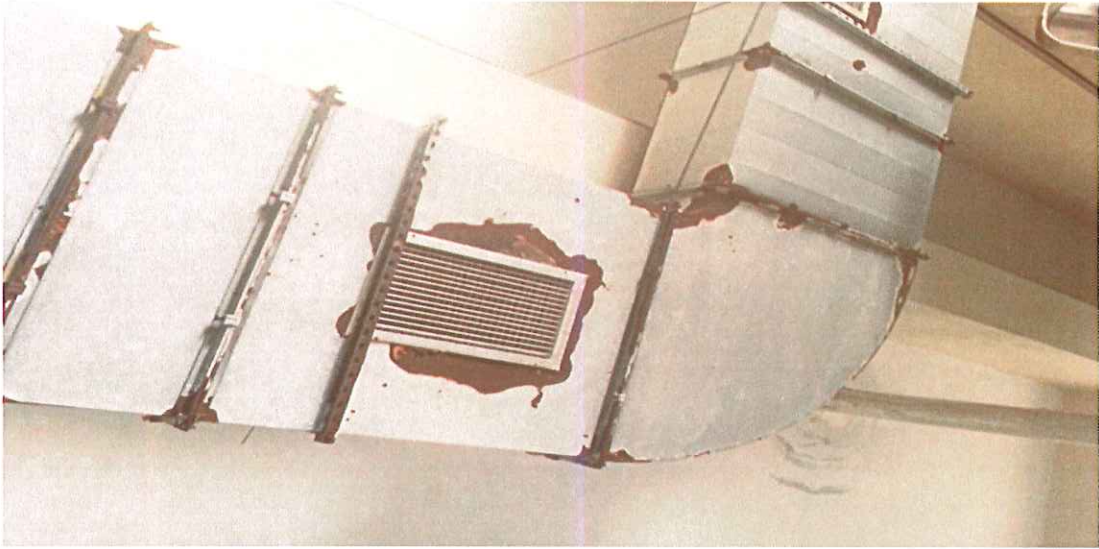
Resim 17: Mezitli Atıksu Arıtma Tesisi'nde yeterli olmayan havalandırma
