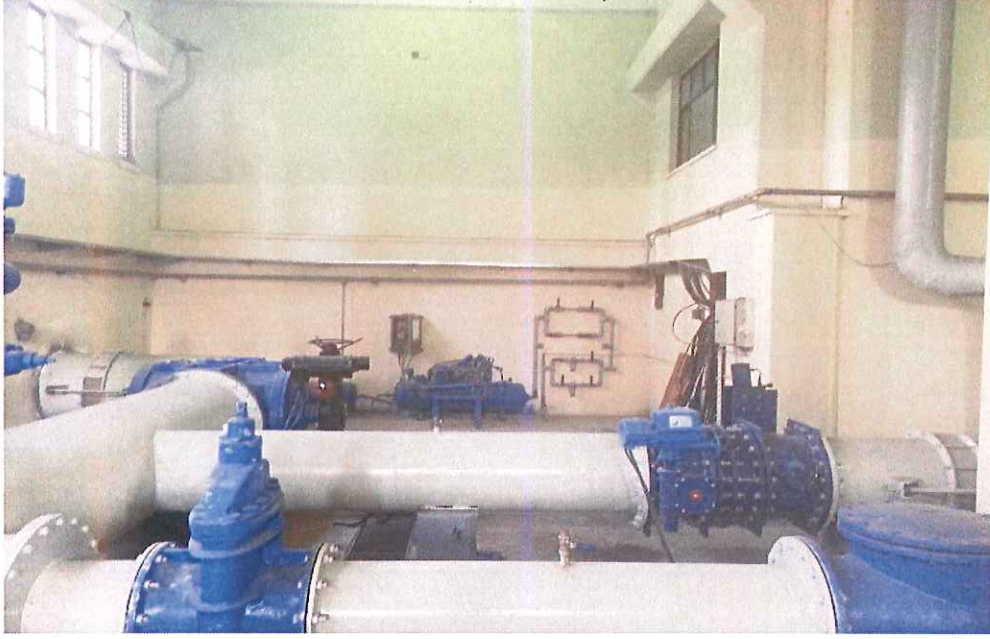
Resim 8: Batı Pompa İstasyonu gürültü ölçümlerinin yapıldığı alanlar
