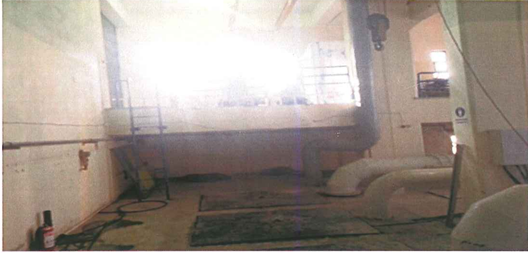
Resim 11: Batı Pompa İstasyonu yeterli olmayan aydınlatma
