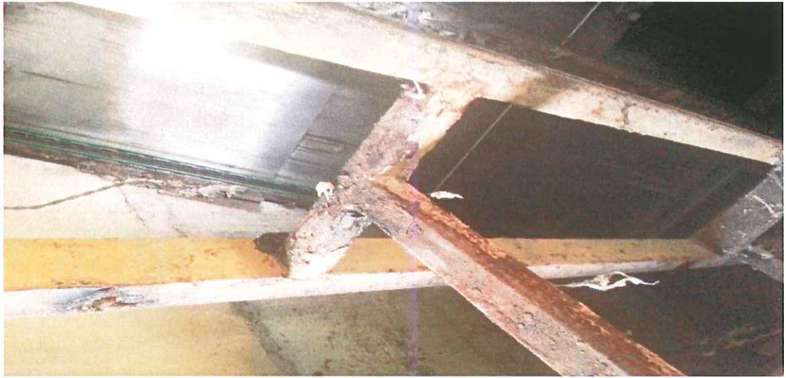
Resim 5: Hidrojen sülfür gazının etkisi
