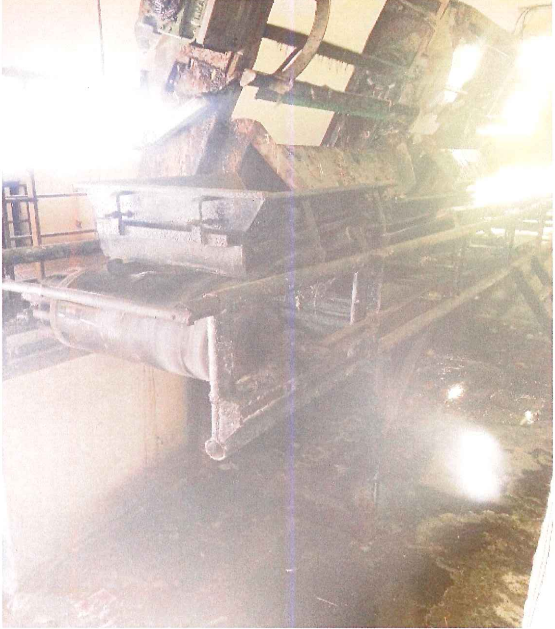
Resim 6: Mezitli Atıksu Arıtma Tesisi'nde hidrojen sülfür gazının ölçümünün yapıldığı alanlar
