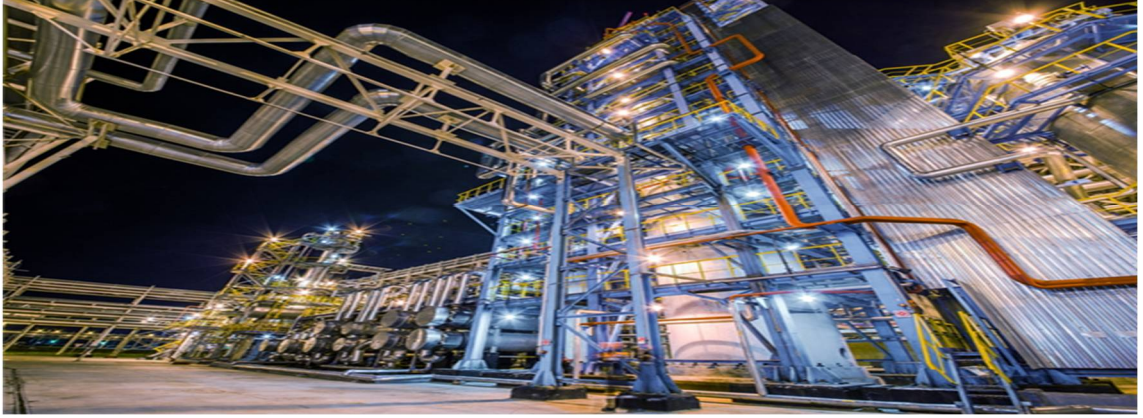
Resim 7: Alüminyum Metal Petrol Boru Hatları
