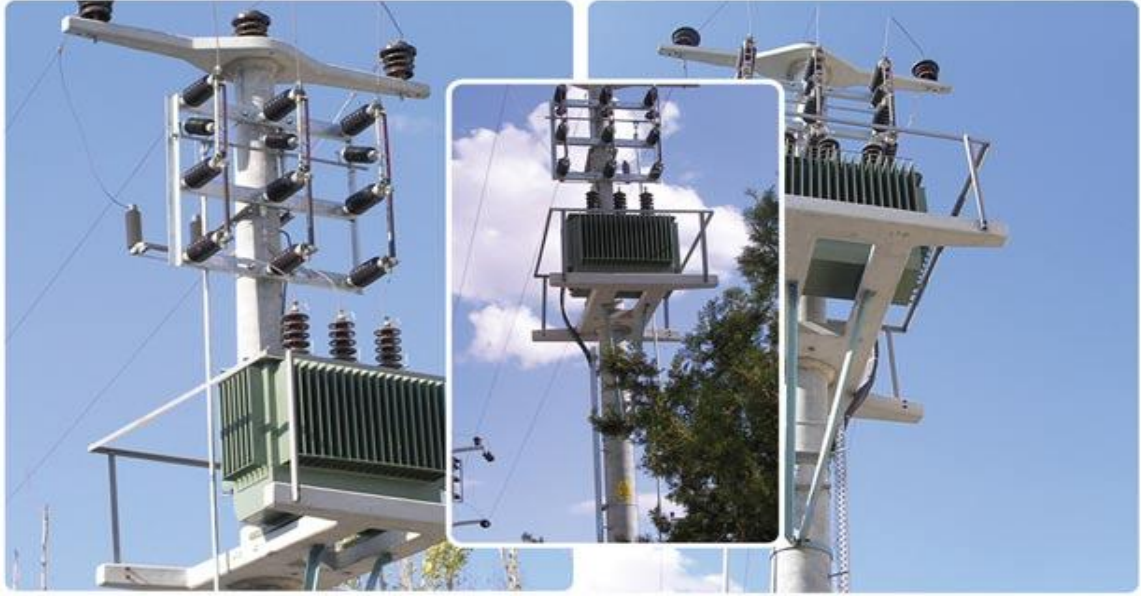
Şekil 3: Direk tipi trafo
