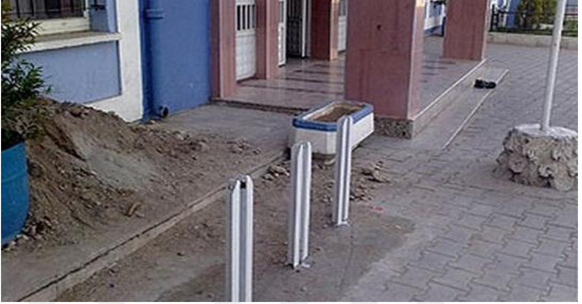
Resim 3- Bayrak diređi yıkılması sonucu oluşan kaza
