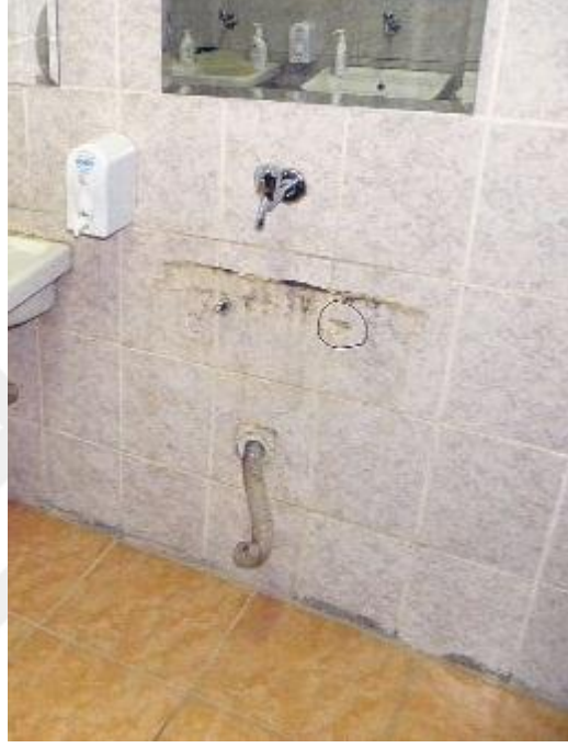
Resim 2- Lavabo kırılması sonucunda oluşan kaza
