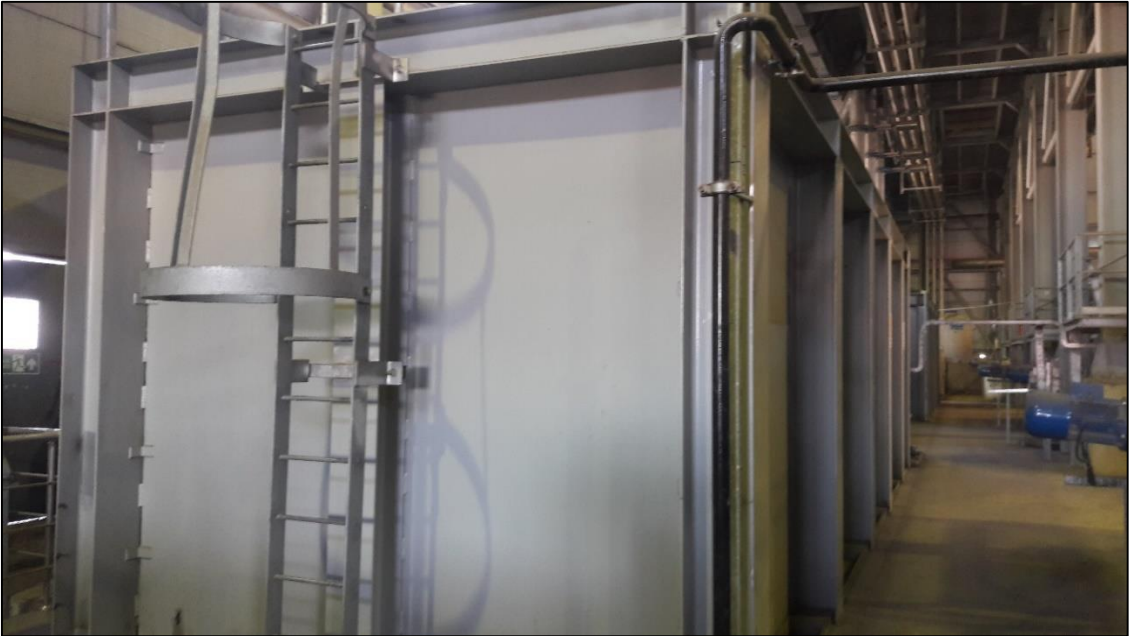
Resim 5: Çamur depolama tankı
