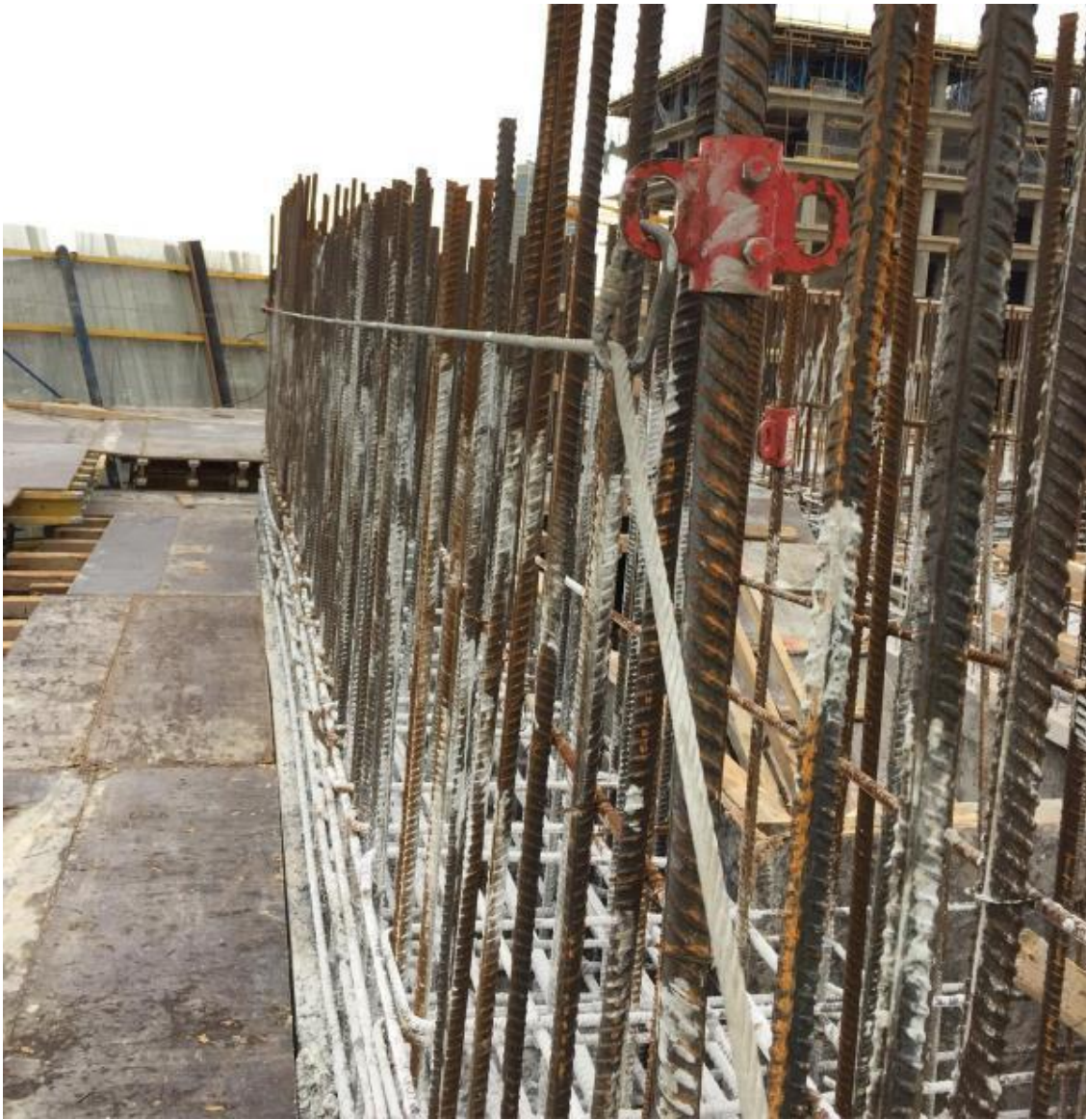
Şekil 138: 15 Metrelik Yaşam Hattının 9.Metresindeki Ara Ankraj
