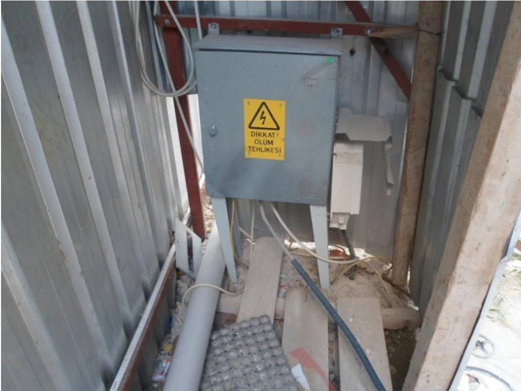
Resim 141: Suadiye mahallesi 23 nolu yapı şantiyesi ana elektrik panosu
