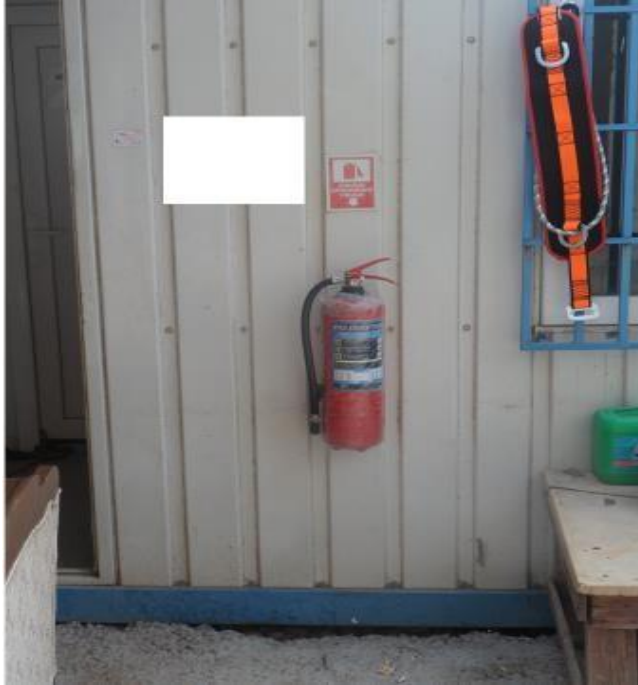
Resim 139: Erenk y mahallesi 14 nolu yapı Őantiyesi i erisinde yangın t pleri
