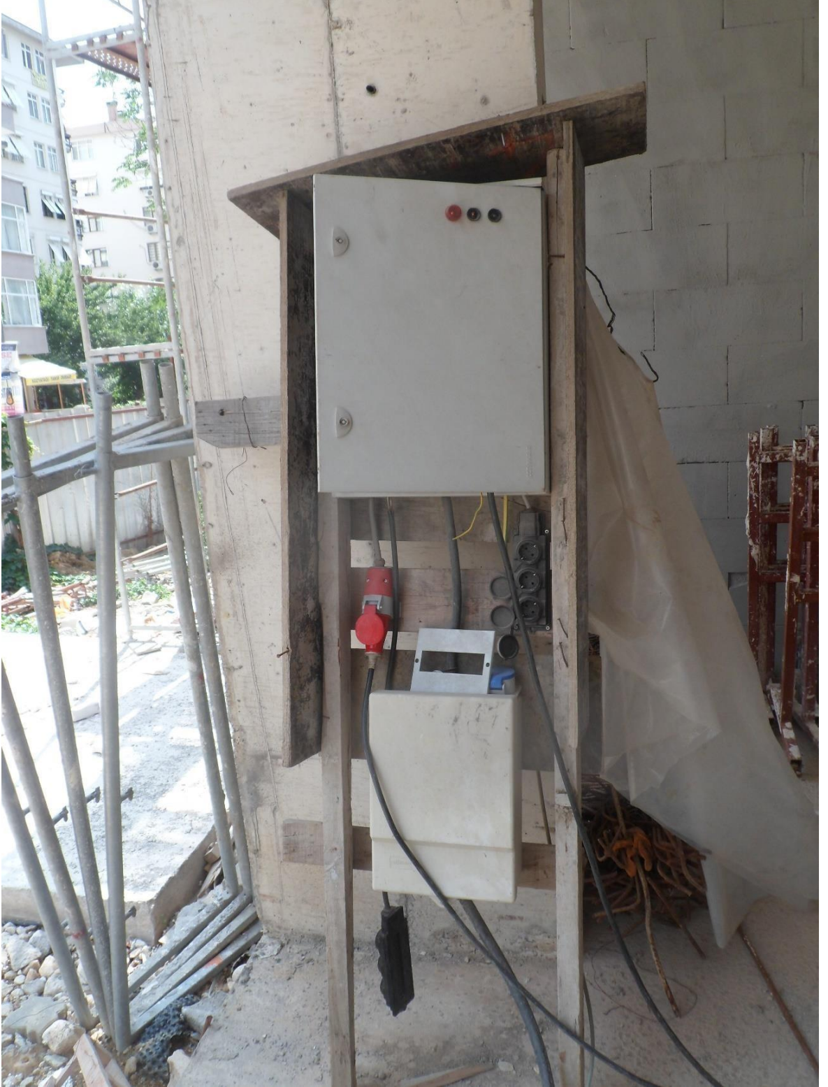
Resim 131: 19 Mayıs mahallesi 7 nolu yapı şantiyesi elektrik ana panosu
