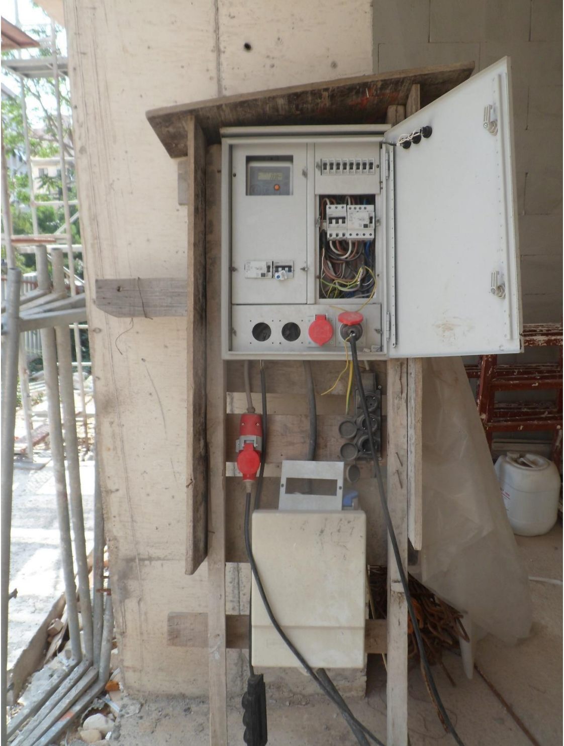
Resim 130: 19 Mayıs mahallesi 7 nolu yapı Őantiyesi elektrik ana panosu
