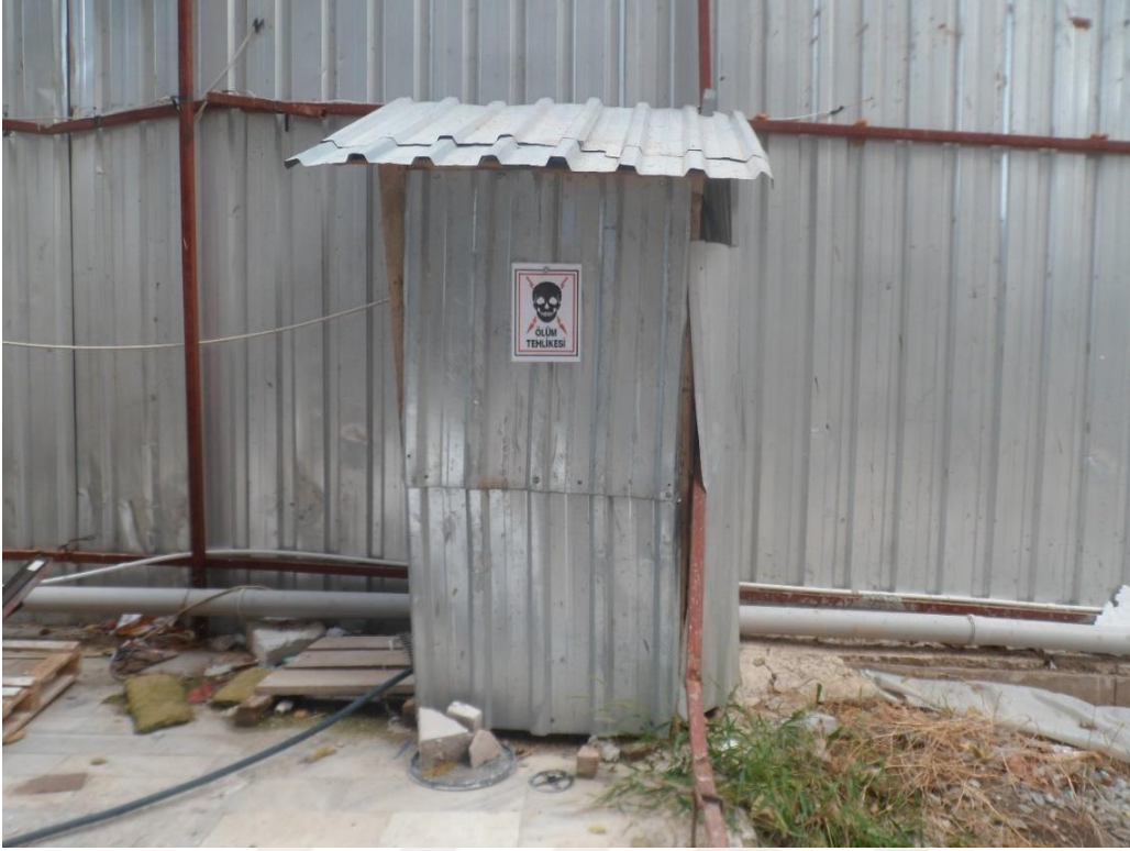
Resim 140: Suadiye mahallesi 23 nolu yapı şantiyesi ana elektrik panosu sundurması
