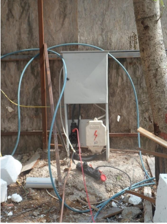
Resim 138: Erenk y mahallesi 14 nolu yapı Őantiyesi ana elektrik panosu
