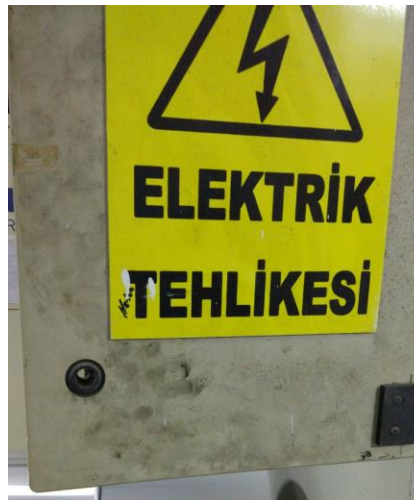
Şekil 20: Kilit mekanizması olmayan pano kapağı
