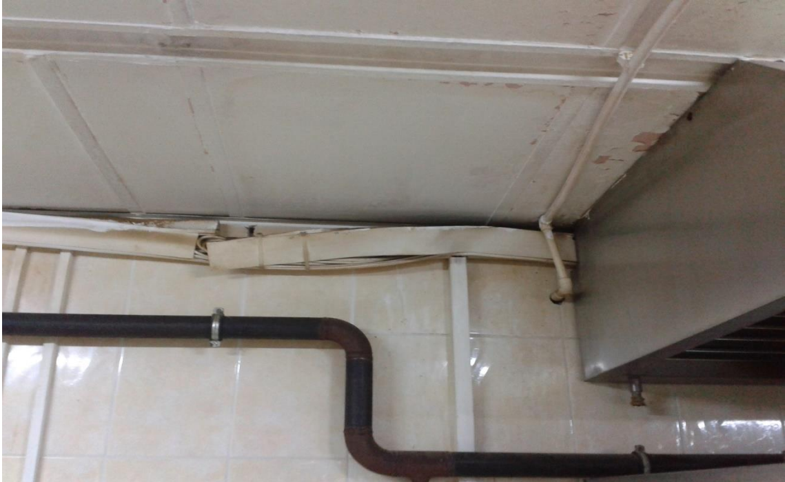
Resim 6: Elektrik kablolarının durumu
