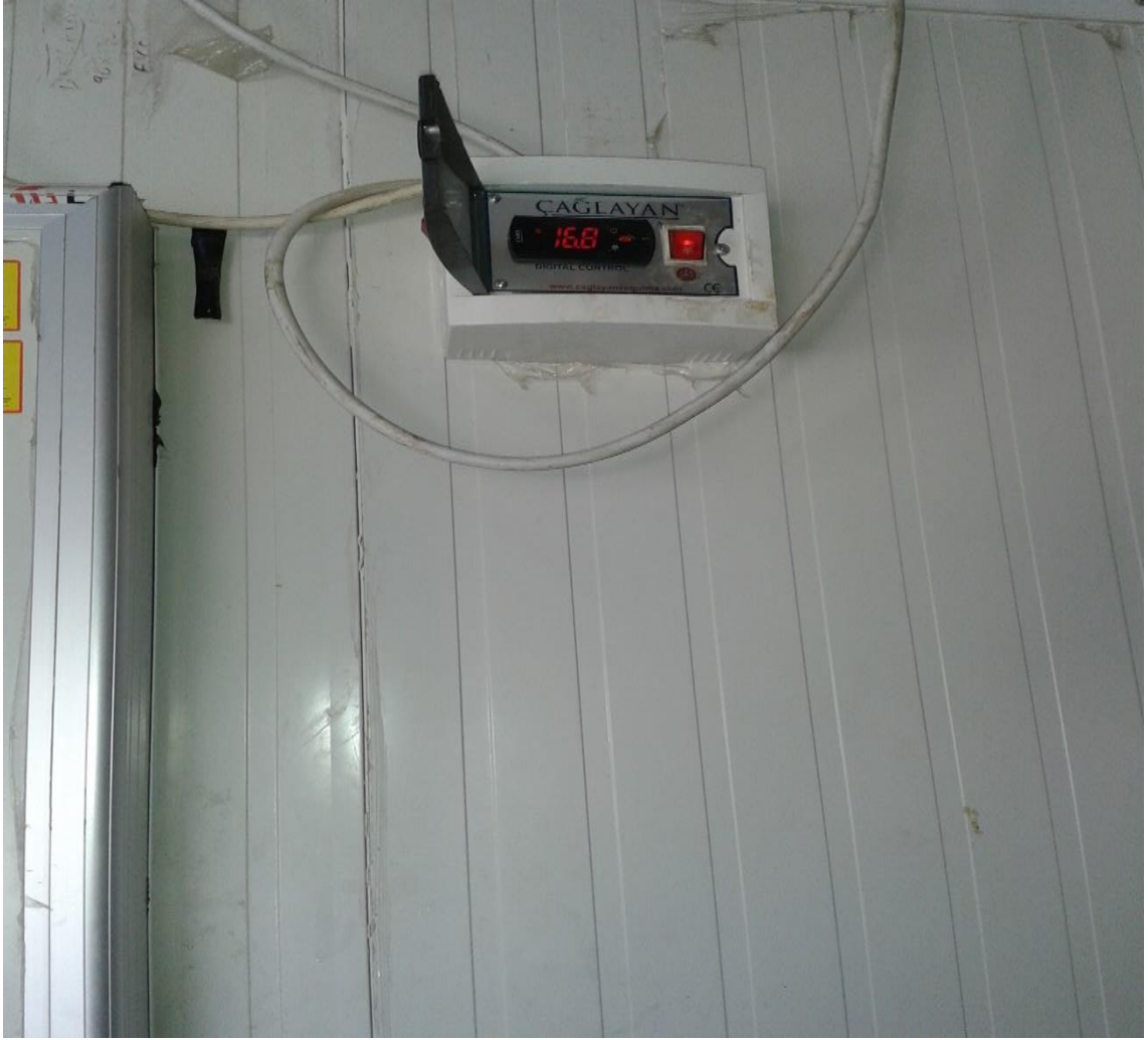
Resim 23: Soğuk depo derecesinin yüksek olması
