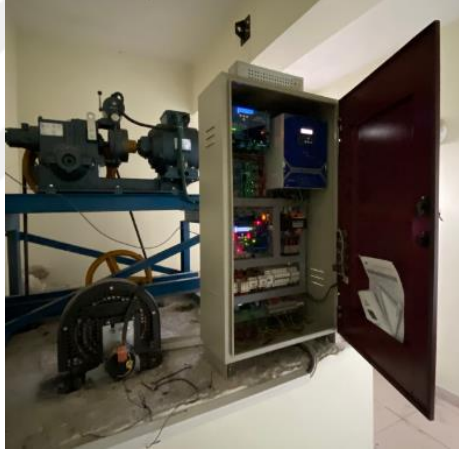
Şekil 14: Yolcu asansörü sistemi kabin hareket motoru, kasnak görüntüsü, elektrik panosu görüntüsü
