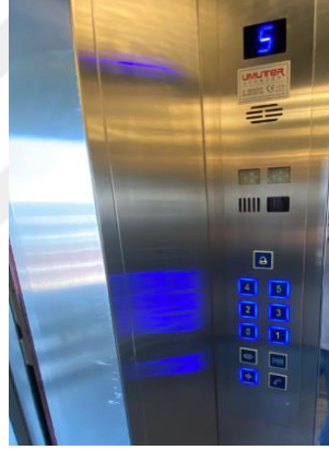
Şekil 10: Yolcu asansörü kabin kontrol paneli görüntüsü
