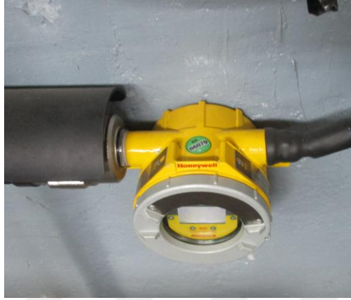
Şekil 2: İç alanda kurulumu yapılmış gaz detektörü
