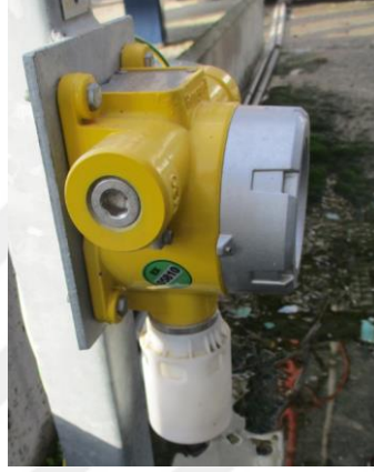
Şekil 1: Dış alanda kurulumu yapılmış gaz detektörü
