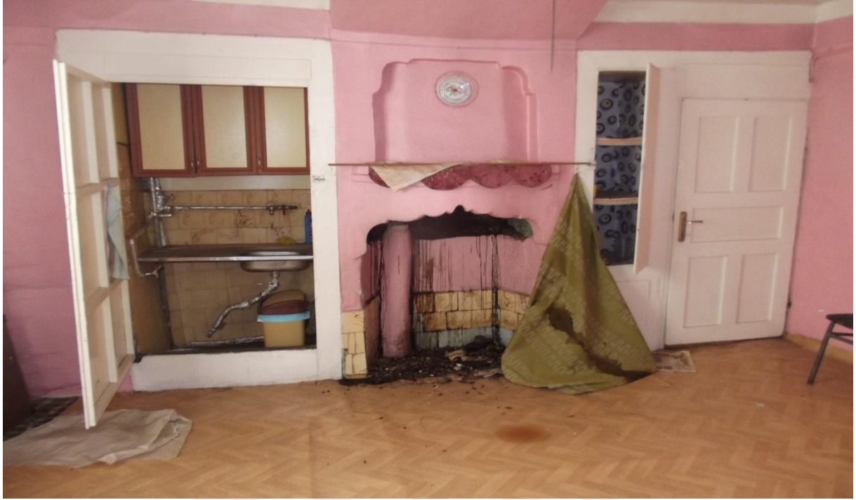
Resim 4.264. Hasan Güzelce evi birinci kat güneydoğu oda girişi, ocak ve dolap uygulaması
