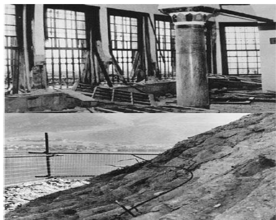
Foto 3.18. 1985 Yıldırım düşmesi sonucu son cemaat yerinin durumu (Στεφανίδου,2009:230).
