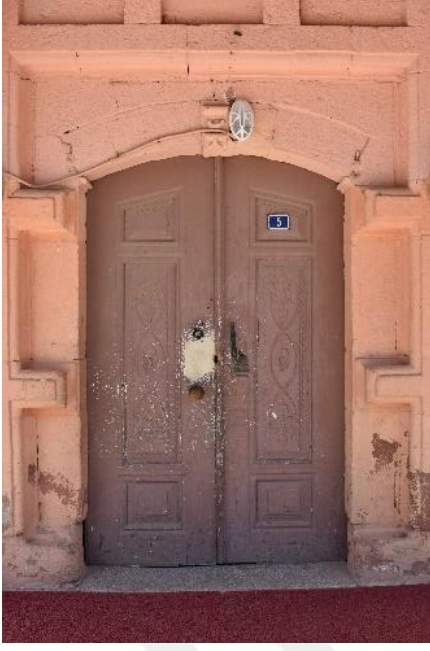
Foto. 3.199. Keskin-Fişekhane binası giriş kapısından detay
