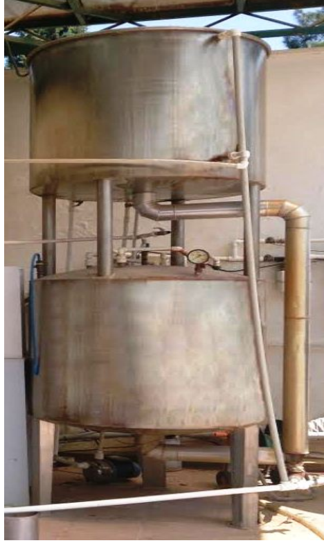
Şekil 3.2 Gazometre tankının görünümü
