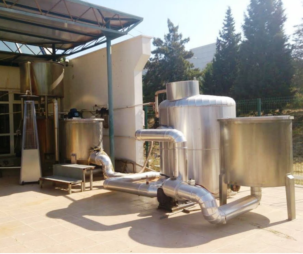
Şekil 3.1 Biyogaz sisteminin genel görünümü
