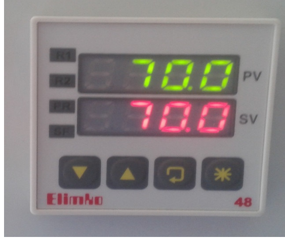
Şekil 5.10: Sıcaklık Kontrol Ünitesi (PID)
