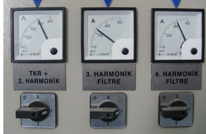
Şekil 4.15: Harmonik filtrelerin kontrol panosu
