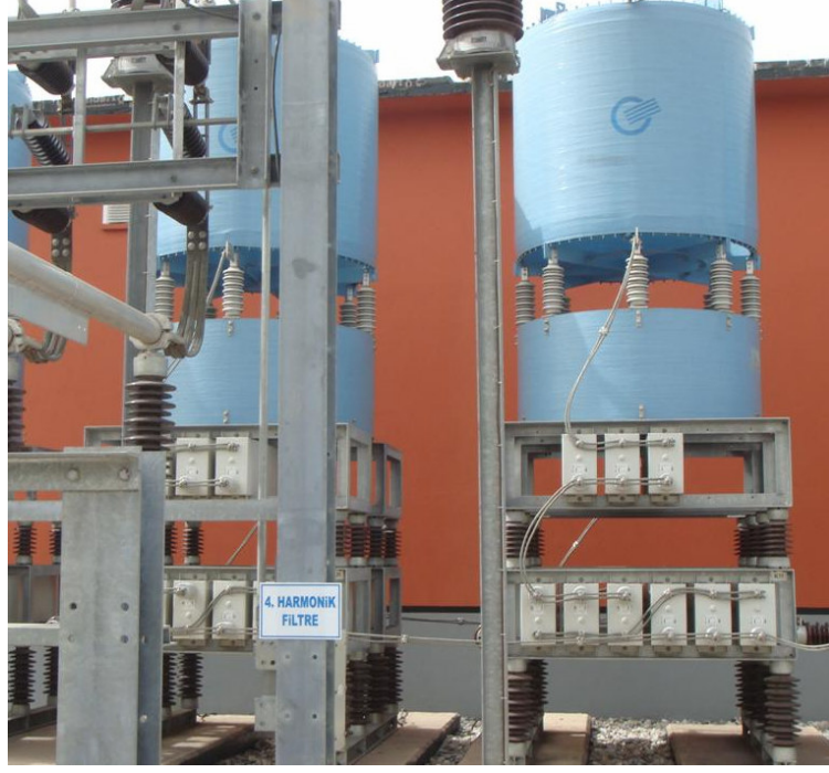
Şekil 4.12: SVC içindeki harmonik filtre ünitesi
