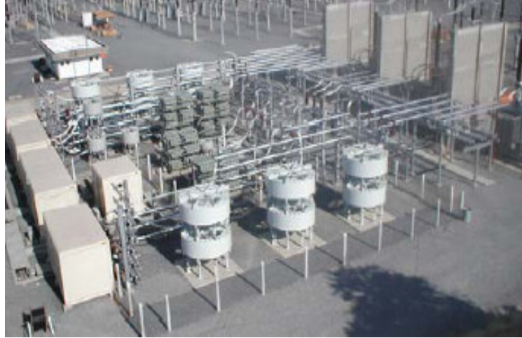
Şekil 4.5: 500 kV gerilimde ve 250 MVar gücünde bir SVC tesisi
