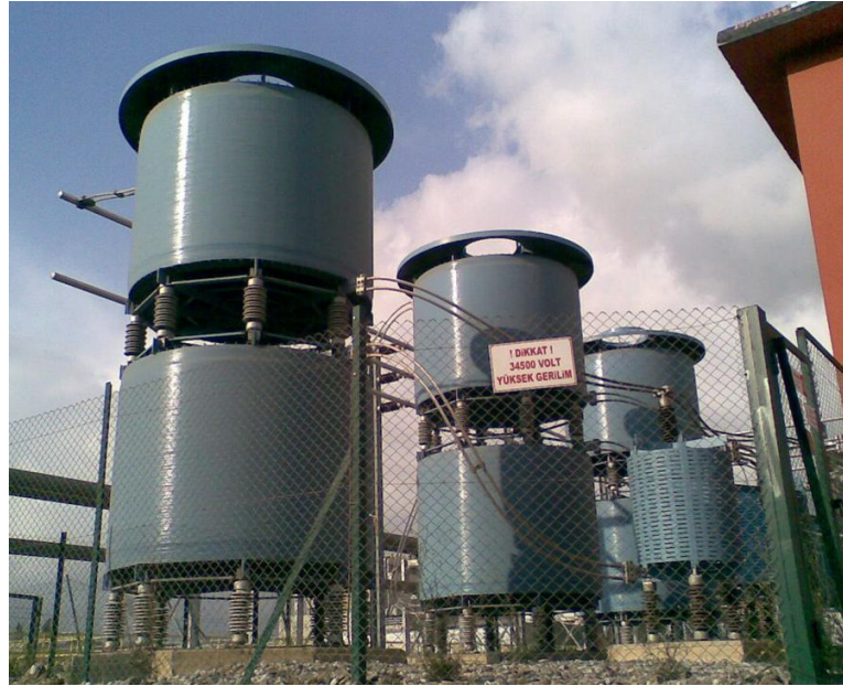
Şekil 4.11: TKR ünitesindeki reaktörler
