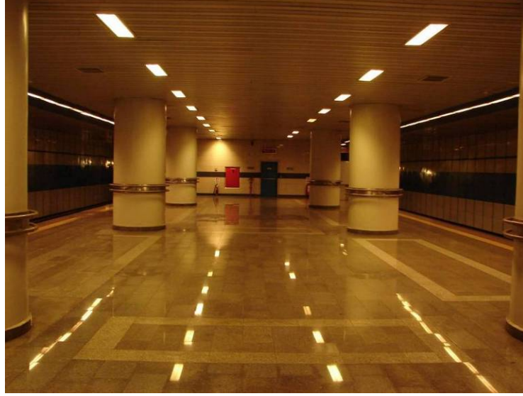
Şekil 7-13 : Levent İstasyonu Konkors Altı Platform Bölge Aydınlatması
