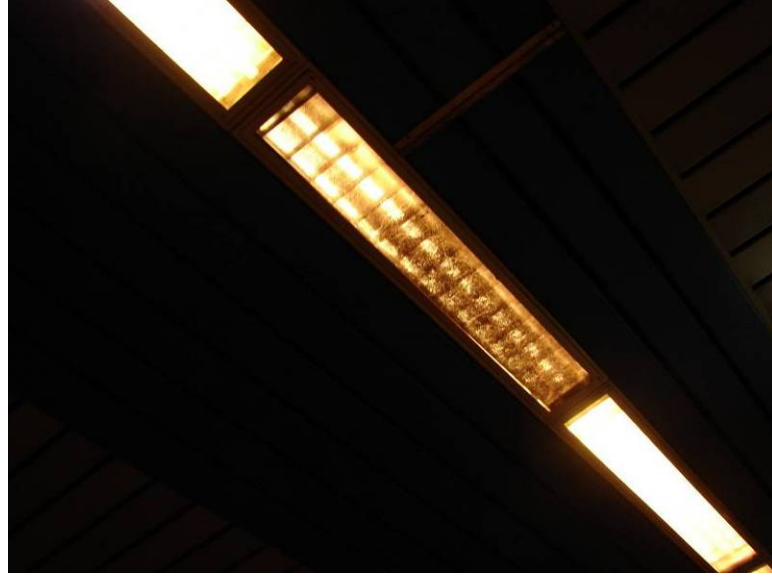
Şekil 7-8 : Çoklu Bir Armatür Sırası İçinde Aşırı Kirlenmiş Armatür
