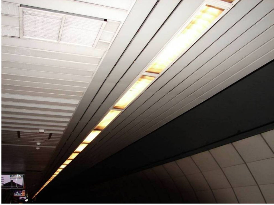
Şekil 7-6 : Şişli İstasyonu Emniyet Çizgisi Üzerindeki Armatür Kirlenmesi
