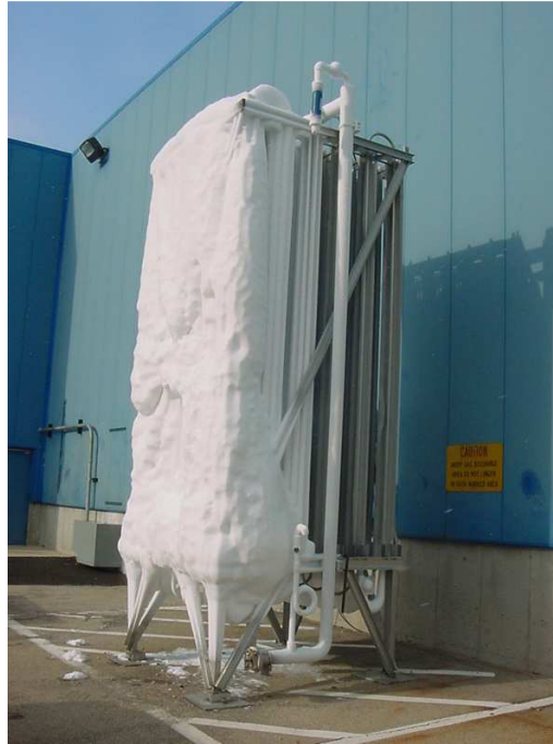
Şekil 2.8 : Evaporatör üzerinde buzlanma oluşumu.
