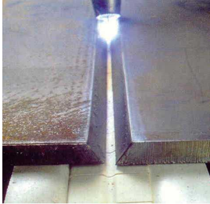
Şekil 4.3. Seramik altlık kullanılarak gerçekleştirilen kaynak işlemi (Oerlikon Kaynak Elektrodları ve Sanayi A.Ş., 2014)
