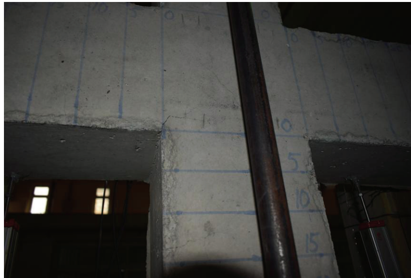
Őekil 5.18 Birleřim blgesinde meydana gelen hasarlar (F3)
