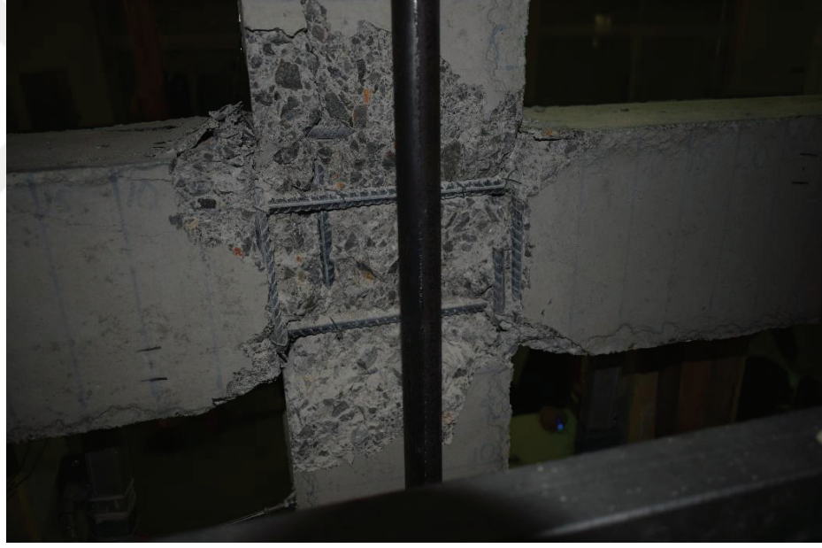
Şekil 5.13 Deney sonrası birleşim bölgesi hasar durumu (arka yüz) (F2)
