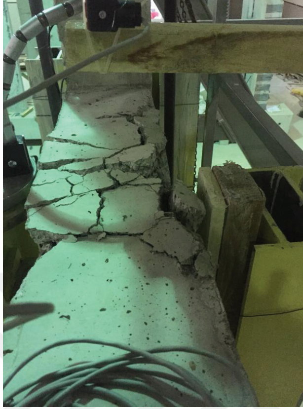
Şekil 5.19 Sol kirişte meydana gelen hasar (üstten görünüş) (F3)
