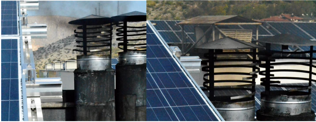
Şekil 4.13. Baca bölgesine yakın panellerdeki yüzey birikintileri.
