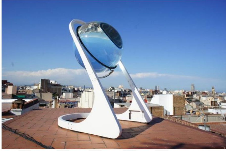
Şekil 12. a) Güneş enerjisi jeneratörü (solar panel)
