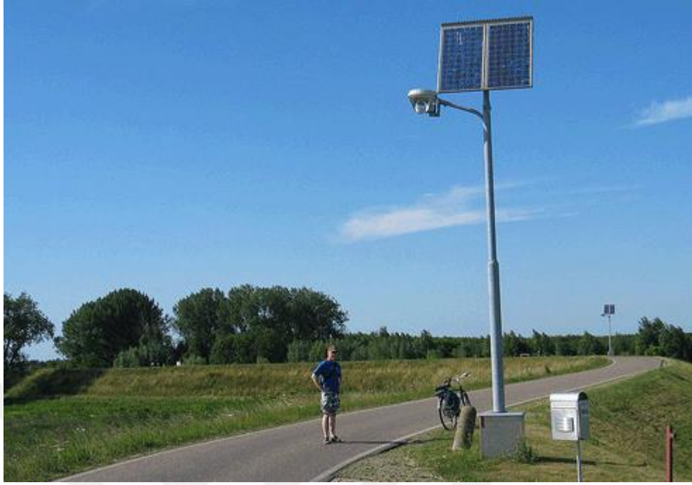
Şekil 4. Güneş enerjisi ile çalışan yol aydınlatma lambası
