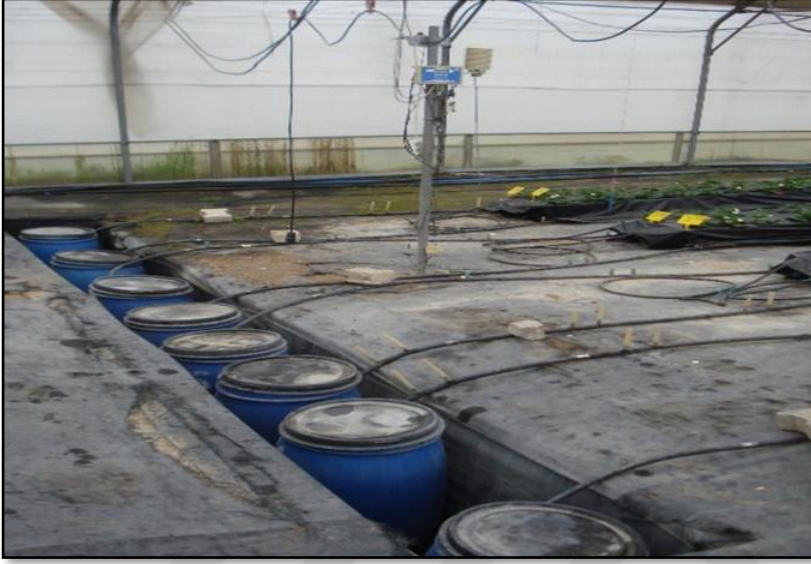
Şekil 3.8. Denemede kullanılan drenaj tankları.
