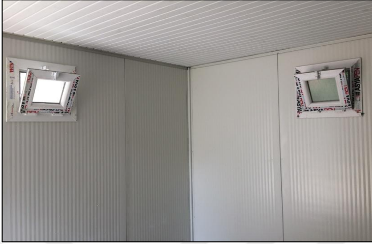
Şekil 2.25. EÜ kimya bölümü yeni atık depo havalandırması
