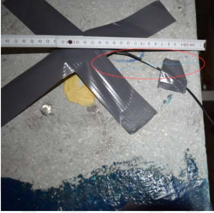
Şekil 4.32.Eğilme çatlağı ilerlemesi
