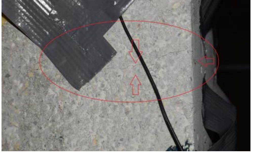
Şekil 4.52.Eğilme çatlağının kiriş ön yüzünde ilerlemesi
