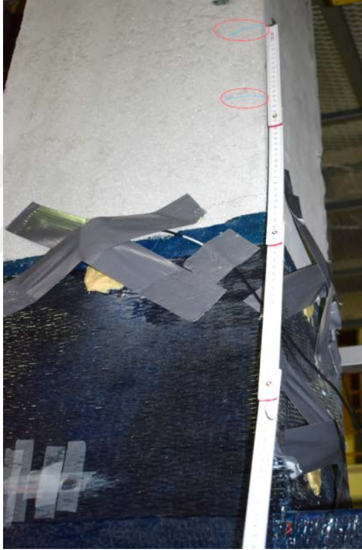
Şekil 4.103. Yeni oluşan eğilme çatlakları
