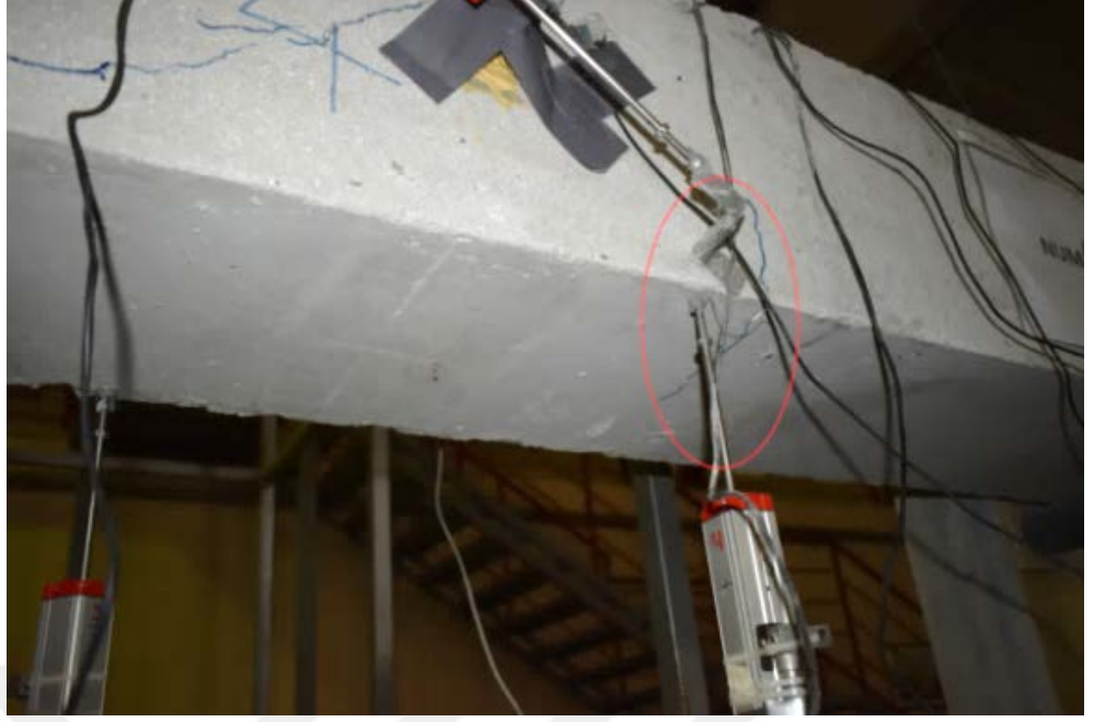
Şekil 4.88.Ön yüz birleşim noktasından kolon alt yüzüne ulaşan çatlaklar
