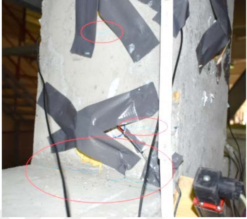
Şekil 4.17. İlk eğilme çatlakları oluşumu
