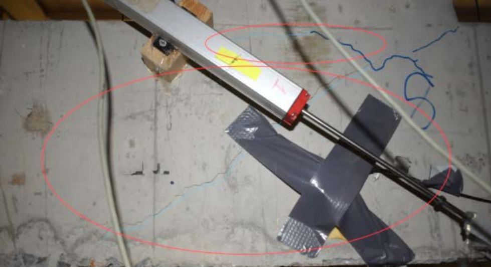
Şekil 4.20. Arka yüz diyagonal ve eğilme çatlakları görünümü
