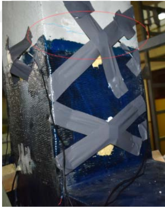
Şekil 4.101.Kiriş sağ yüzeyindeki eğilme çatlakları
