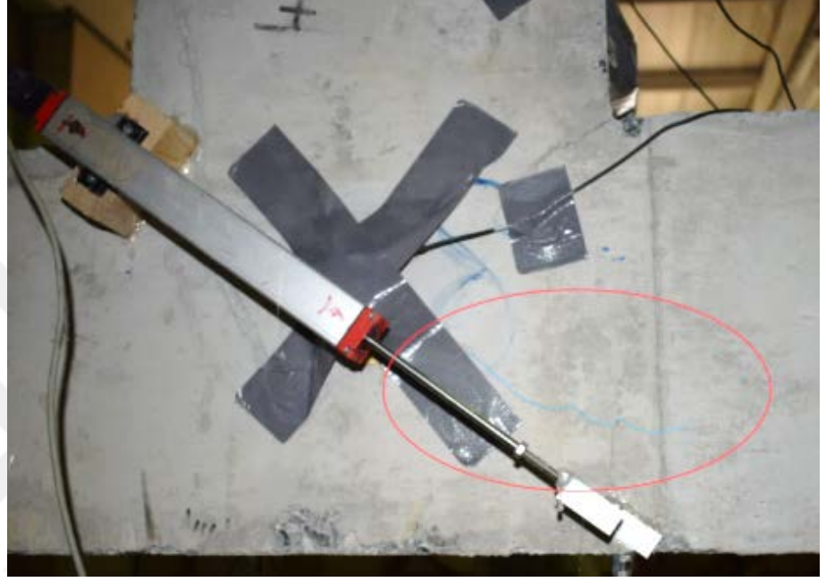
Şekil 4.84.Arka yüzeyde diyagonal çatlak görünümü
