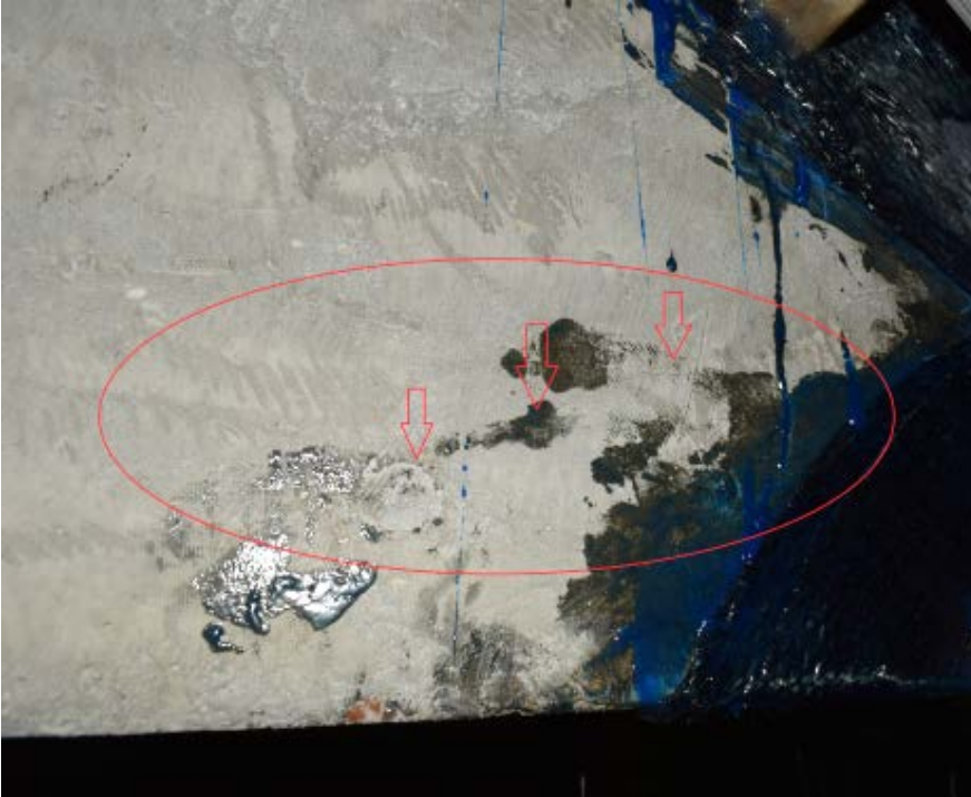
Şekil 4.54. Diyagonal çatlak görünümü
