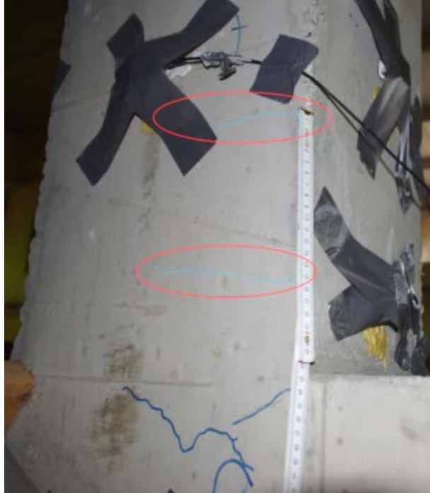
Şekil 4.21. Eğilme çatlakları görünümü
