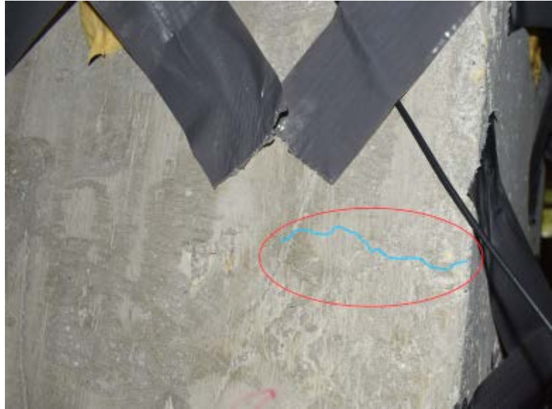
Şekil 4.53.Eğilme çatlağının kiriş arka yüzünde ilerlemesi
