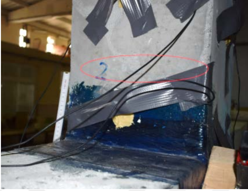
Şekil 4.30. İlk eğilme çatlaklı görünümü
