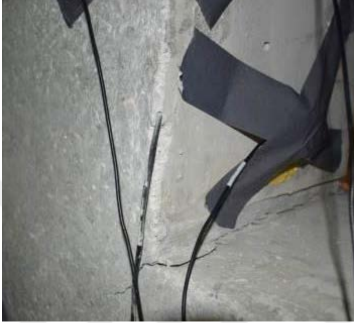
Şekil 4.72. Birleşim noktası çatlak görünümü
