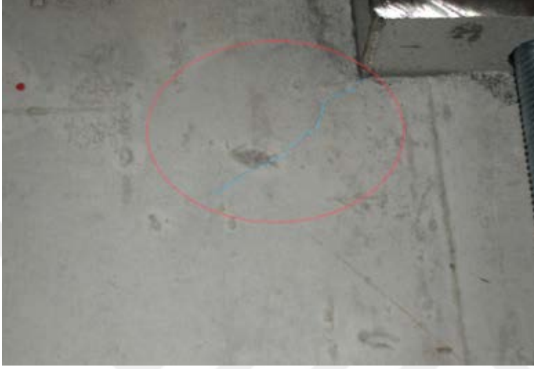
Şekil 4.137.Arka yüzeyde diyagonal çatlak oluşumu
