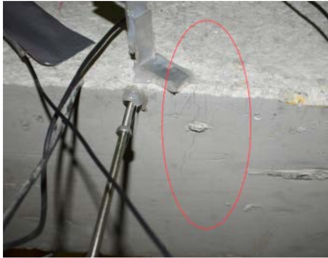
Şekil 4.71. Kolon alt yüz eğilme çatlakları görünümü
