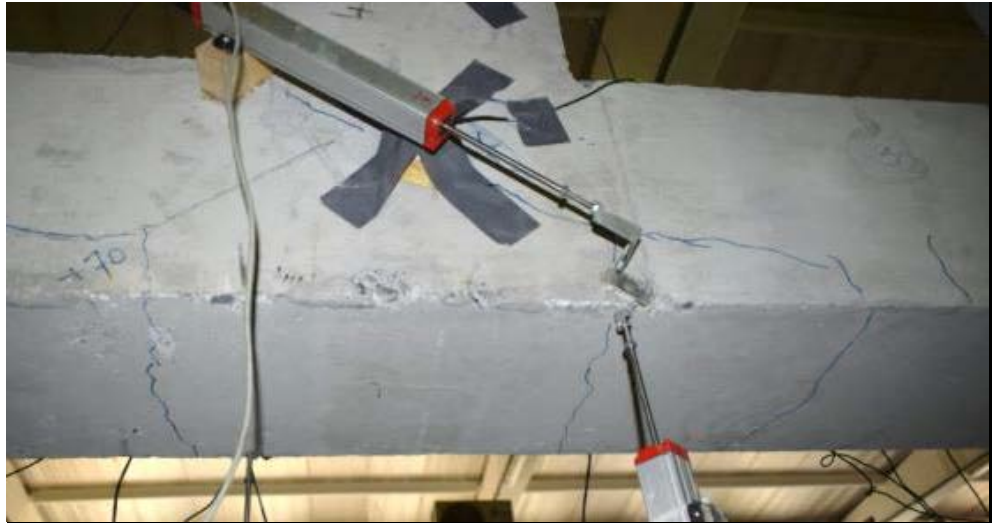
Şekil 4.89.Kolon alt yüzeyindeki çatlaklar
