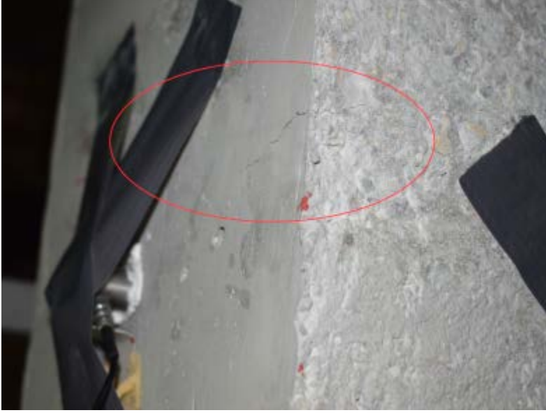
Şekil 4.7.Eğilme çatlağı görünümü
