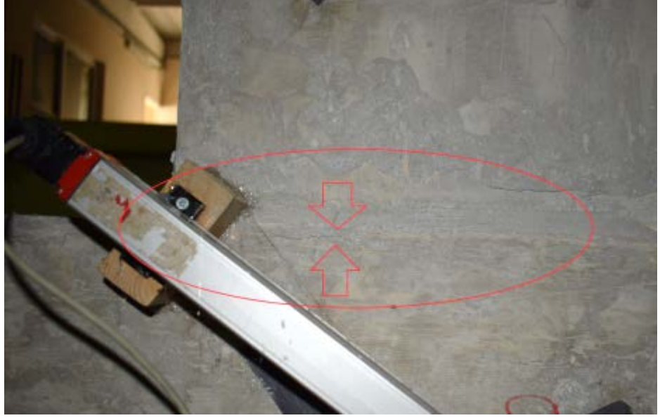
Şekil 4.4.Arka yüz çatlak durumu
