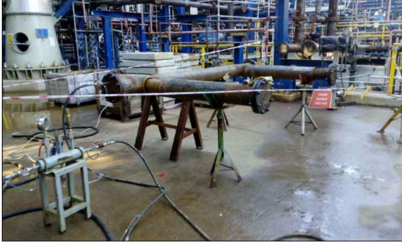
Şekil 2.2 Star Rafinerisi'nde yapım aşamasında bir proje borusunun sızdırmazlık ve basınç testi (Kişisel arşiv)
