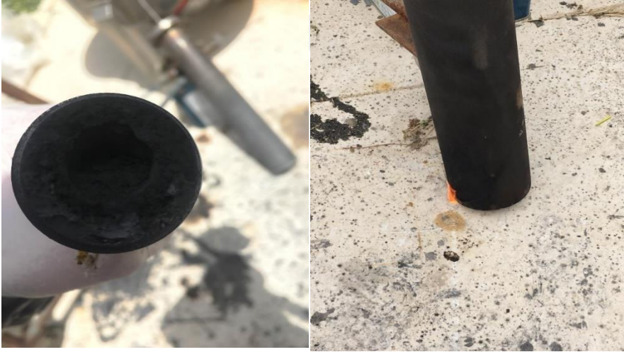
Şekil 5.2 Gaz çıkış hattındaki tıkanıklık ve sızıntı yapan reaktör
