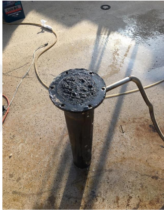
Şekil 5.1 Gazometre suyu taşınarak tıkanan reaktör
