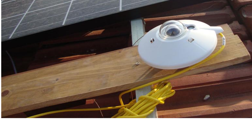
Resim 6.3. Çatıya montajı yapılan ışınım sensörü ve ölçüm devresinin genel görünüm
