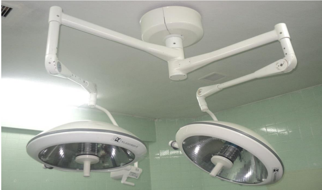
Şekil 4.4. Ameliyat alanı aydınlatma sistemi
