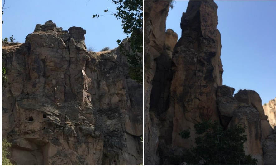
Şekil 3.6: Dolgu malzemesinin yıkandığı bloklardan görünüm.
