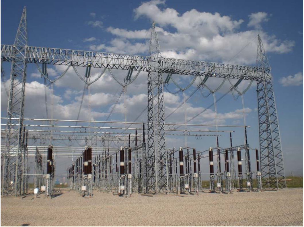
Resim 9: Afşin Elbistan Çobanbeyli Şalt Sahası
