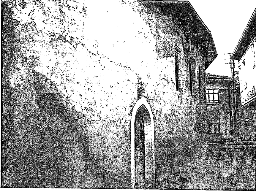
Resim-301 Akşehir Orta Hamam. Kadınlar kısmı soyunmalığının batı duvarı.
